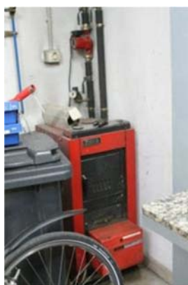
Figura 26. Caldera de Gasoil inicial
