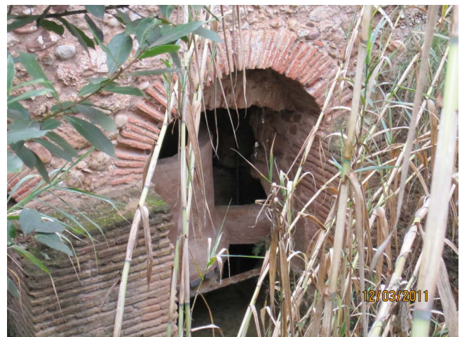
Figura 4. Detalle de un entrador de agua
