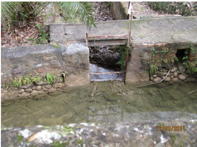
Figura 11. Entrador de agua
