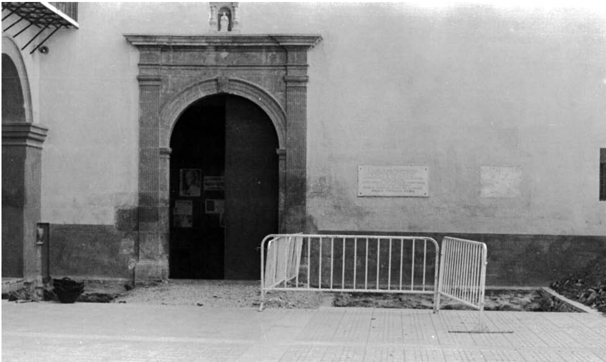
1. Vista de los sondeos realizados en la fachada de la Basílica en 1982 (foto SIAP).
