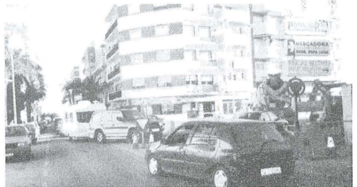
Un camió de ciment no pot circular amb normalitat a la nova rotonda i ha de fer maniobra Foto Mateu
