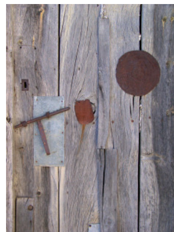
Fig. 197. Antes de la era del consumo compulsivo, los objetos se reparaban cuando se deterioraban y por eso tenían un ciclo de vida más largo, como esta puerta de madera parchada.
