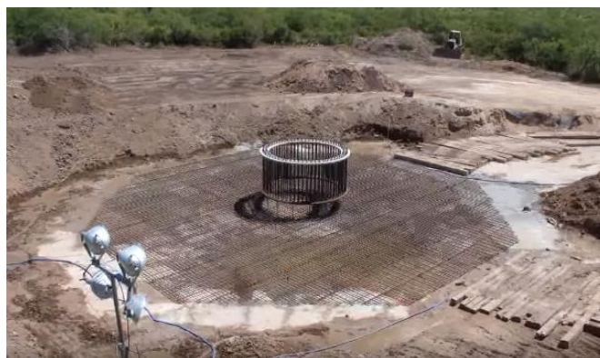
Figura 82 - Instalación de la virola sobre la que irá asentada la base de la torre del aerogenerador. Fuente: Acciona.
