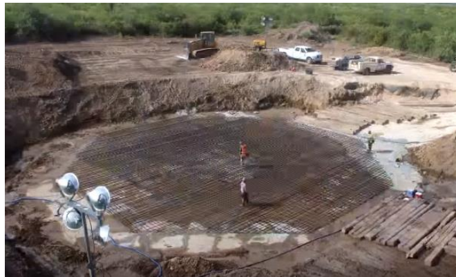
Figura 81 - Instalación de las barras de acero corrugadas para la base de zapata de la cimentación. Fuente: Acciona.
