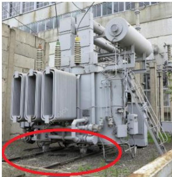
Figura 120 - Carriles en la bancada de transformador. Fuente: Depositphotos
