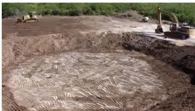
Figura 79 - Hueco para la zapata durante la construcción de la cimentación de un aerogenerador. Fuente: Acciona.
