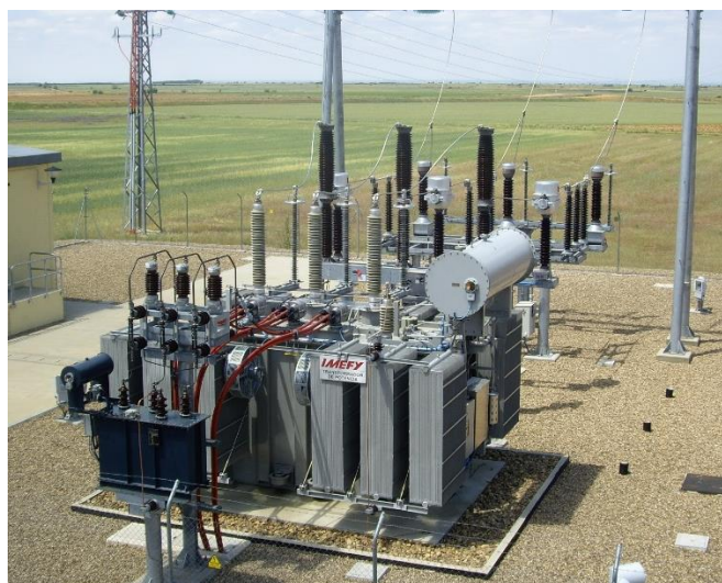
Figura 98 - Transformador genérico en una subestación eléctrica. Fuente: dicyt.com
