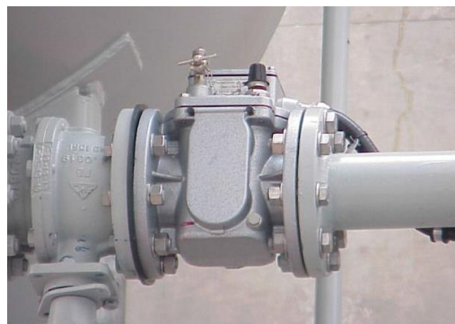
Figura 103 - Fotografía de un relé Buchholz ya instalado. Fuente: Globecore
