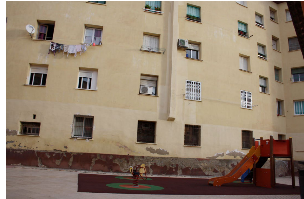
Figura 3. Lindes del patio de infantil del CEIP Maestro López Soria, mediante edificaciones medianeras en deficiente estado de conservación.
