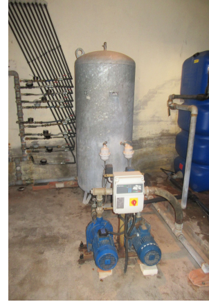
(Figura 15: Cuarto de bombas agua)
