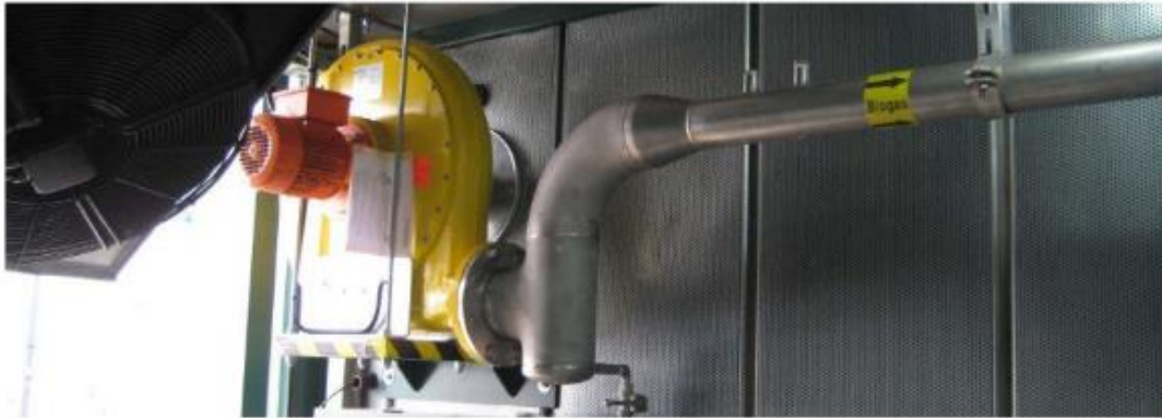
ILUSTRACIÓN A2.3: COMPRESOR A LA ENTRADA DEL GAS
