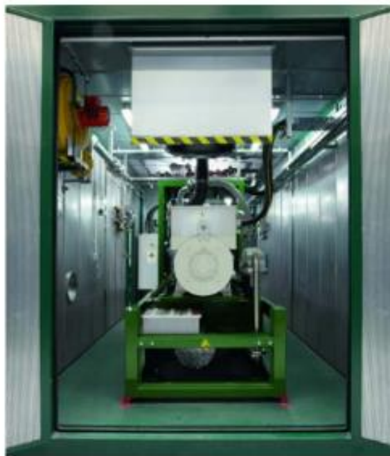
ILUSTRACIÓN A2.5: VISTA INTERIOR DEL CONTENEDOR
