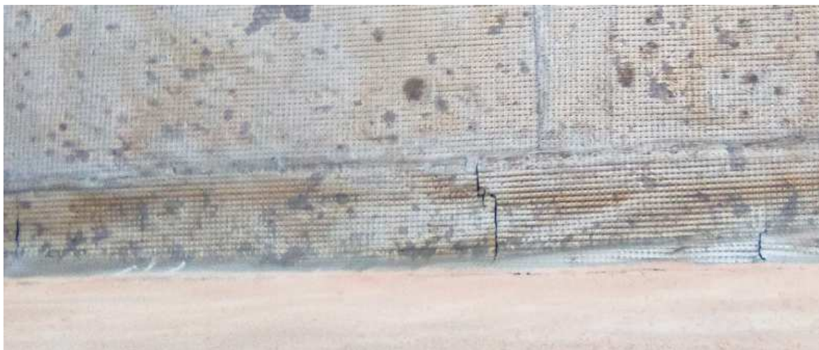
Figura 6: Impermeabilización de cubierta en mal estado. Fuente propia.
