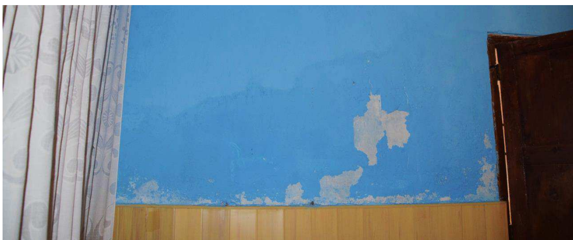
Figura 19: Atura de humedad que ha aumentado debido al revestimiento plástico impermeable colocado para tapar las manchas con menor cota que existían con anterioridad. Fuente propia.
