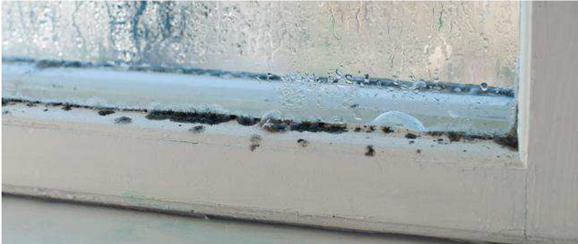
Figura 9: Humedad y moho en la carpintería de una ventana. Fuente: BT.
