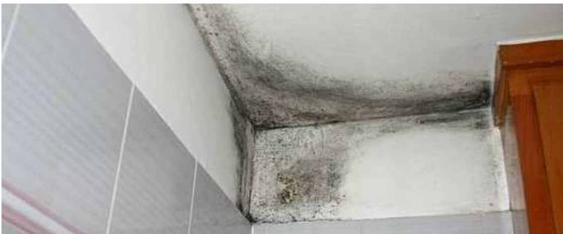
Figura 10: Manchas de moho producidas por la humedad de condensación. Fuente: Diyandbuild.
