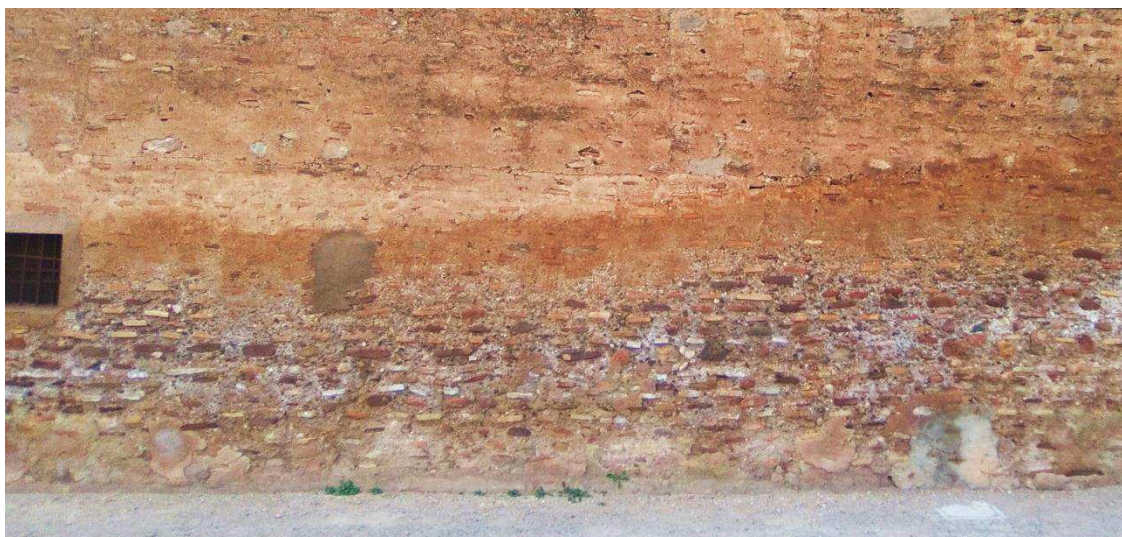
Figura 18: Muralla afectada por humedades ascendentes donde se distingue perfectamente la franja húmeda. Fuente propia.
