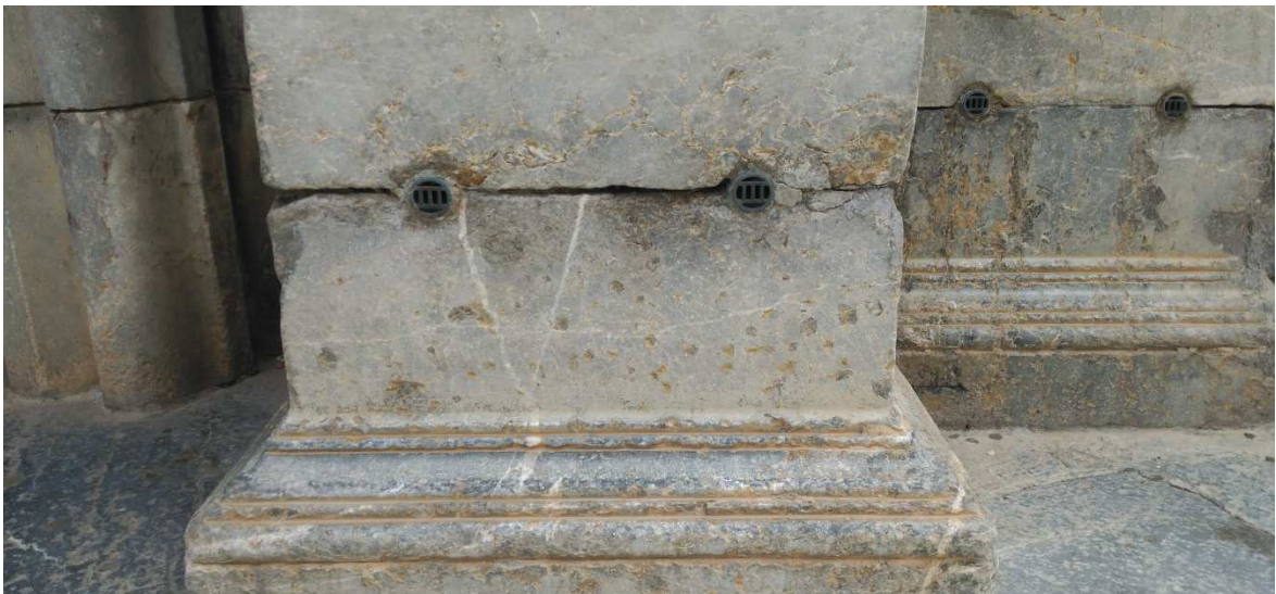
Figura 40: Instalación de sifones atmosféricos terminada. Iglesias Santas Justa y Rufina, Orihuela. Fuente: Angel Pitarch.
