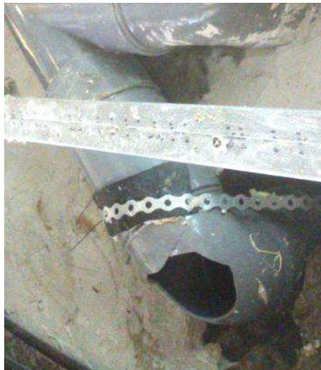
Figura 13: Tubería de saneamiento despedazada. Fuente: Fontanería Caudal.
