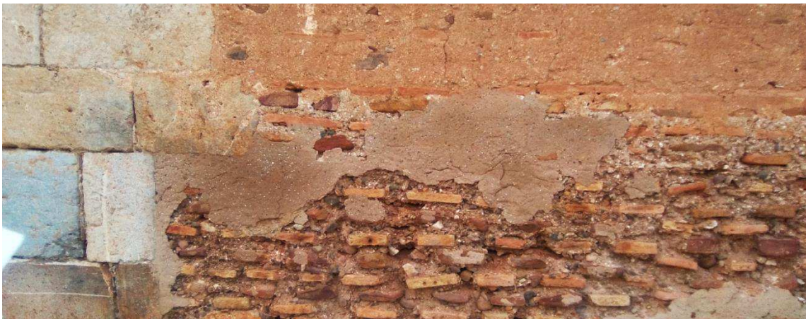
Figura 21: Detalle del deterioro del material del muro a causa de la humedad capilar.
