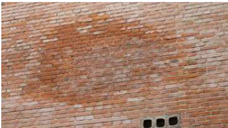
Figura 11: Mancha de humedad accidental. Fuente: Luis Monteagudo.
