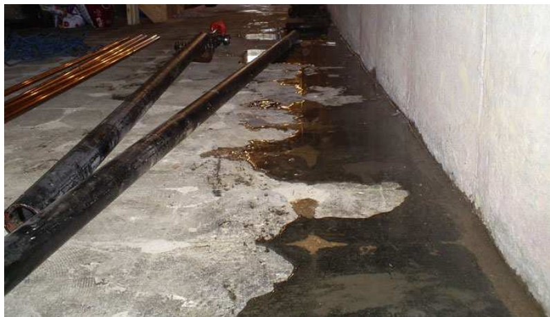
Figura 3: Filtración de agua en un garaje. Fuente: Basementsystems.
