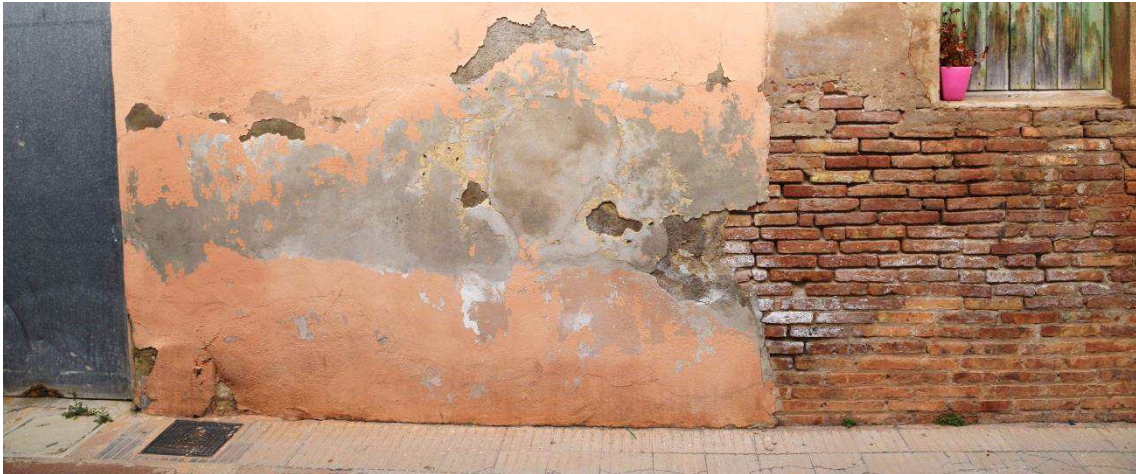
Figura 7: Deterioro de un muro a cause de la humedad por capilaridad. Fuente propia.
