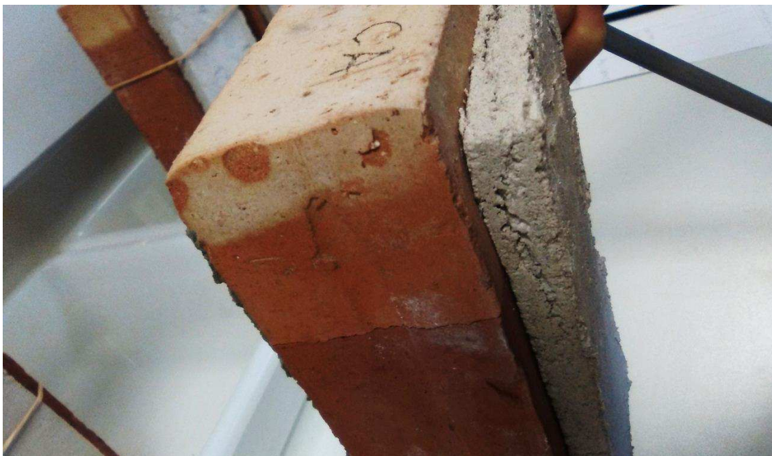
Figura 75: Nivel de humedad condicionado por una fisura en el ladrillo. Fuente propia.
