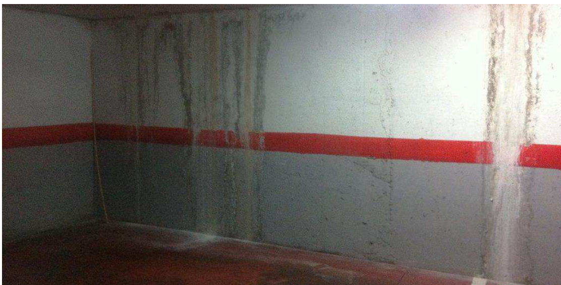
Figura 2: Infiltración de agua en un garaje. Fuente: HUME Ingeniería.
