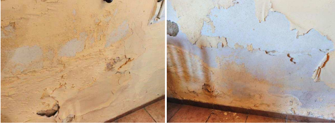
Figura 90: Desconchados causados por la humedad capilar. Fuente propia.
