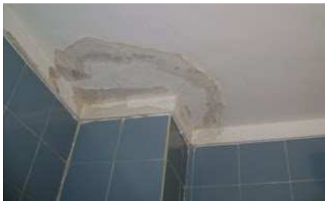
Figura 12: Mancha de humedad accidental debida a una fuga en una conducción. Fuente: LXV Arquitectos.
