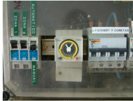
Circuitos de control
