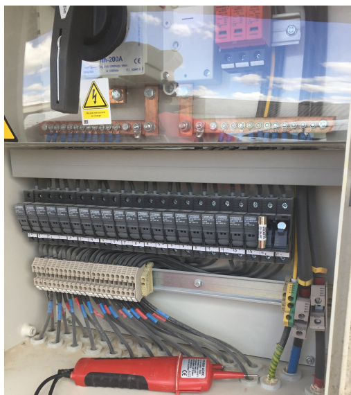
Figura 5: Caja de conexiones.
