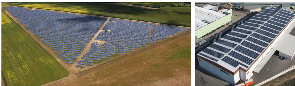
Figura 6: Instalaciones sobre suelo y cubierta.
