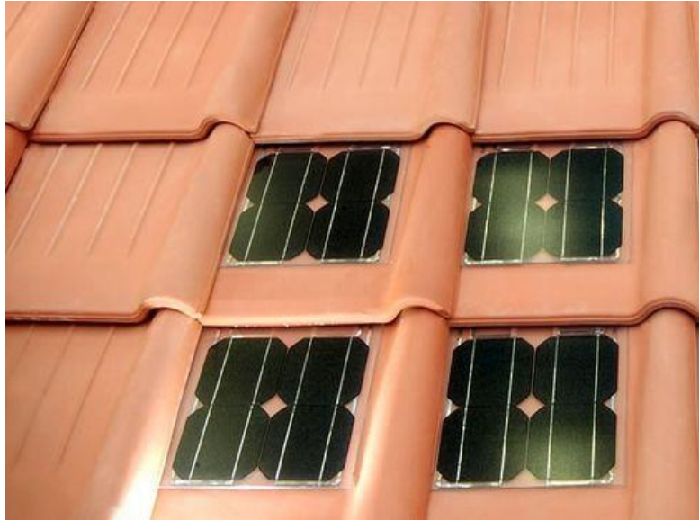
1.23 Tejas Tegasolare instaladas en un techo.
