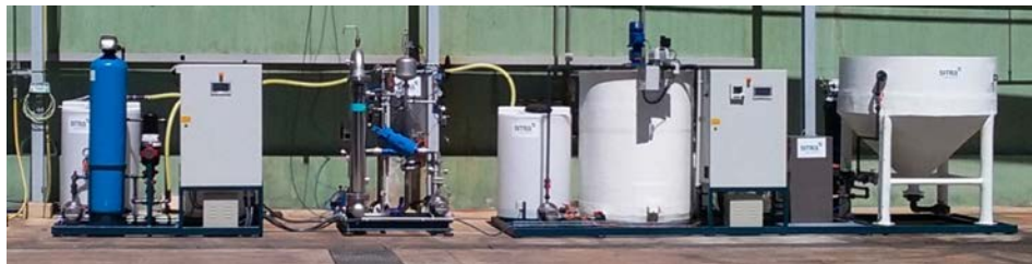
Figura 8.2. Piloto instalado en la EDARI como tratamiento terciario
