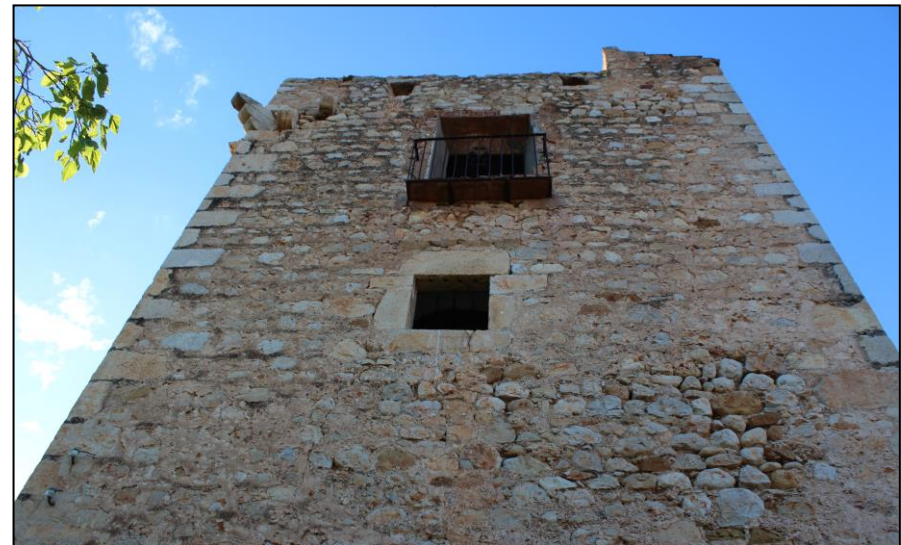
43. Fachada Sudeste donde se aprecia el balcón construido on posterioridad y la garita destruida en la esquina izquierda. Fuente: R.Verdoy
