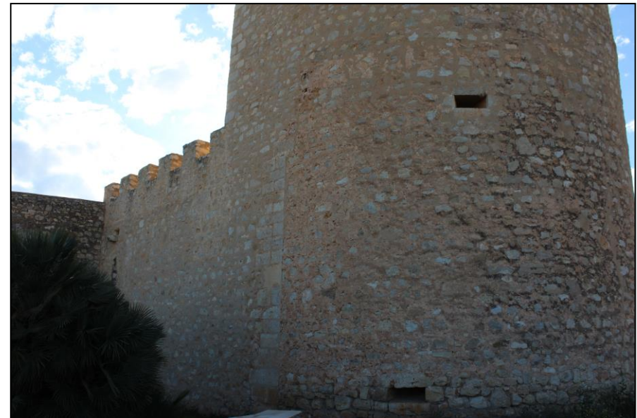
69. Fotografía del exterior de la ermita, en la cual se observan las aspilleras de la torre, orientadas a diferentes puntos cubriendo la mayor visibilidad posible. Destaca también el almenado de la cubierta de la ermita. Fuente: R.Verdoy
