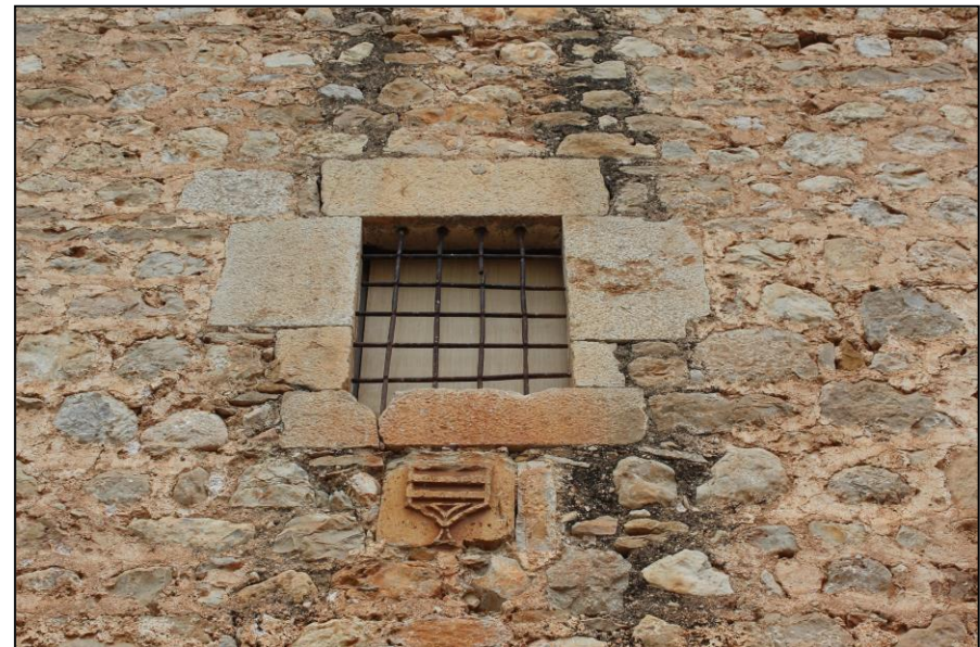
26. Fotografía de la ventana de la fachada principal de Torre del Carmelet. Se observa la sillar reforzando el vano.
