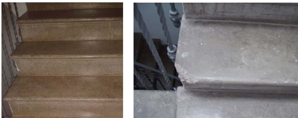
Figura 4.7.1.5. Losas de piedra artificial y cemento
