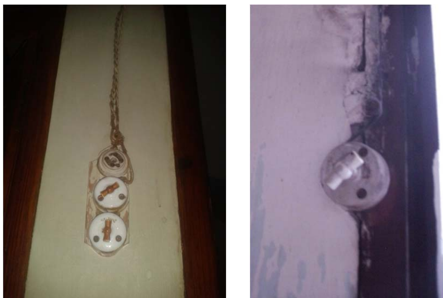
Figura 4.8.1.1. Cableado e interruptores.
