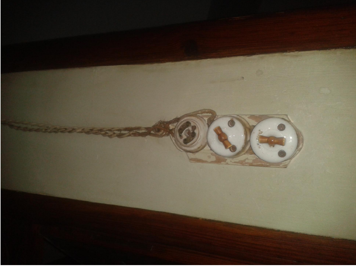
Suministro eléctrico. Red. [Ref. IN006]
