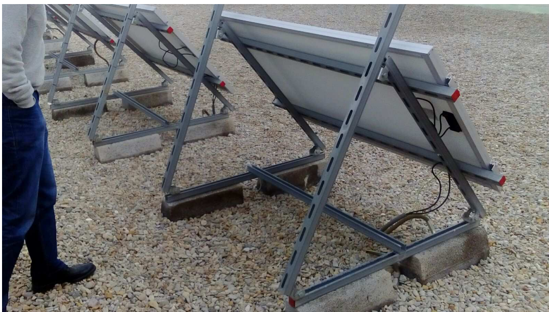
Foto 113. Subestructura estándar para placas fotovoltaicas / [equipe VIA-UJI]
