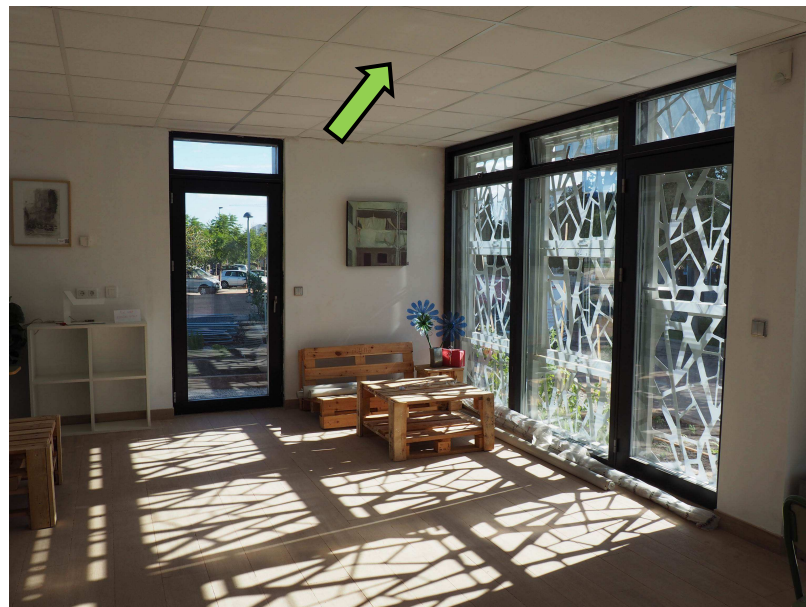
Foto 165. Falso techo desmontable de placas de lana de roca éBRICKhouse 2016 / [EP]
