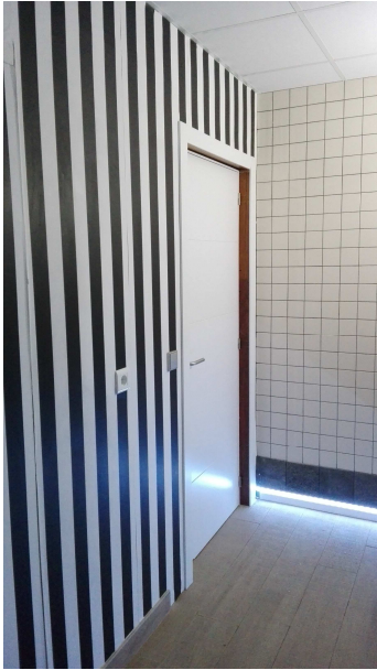
Foto 166. Pared sur del baño [EP]
