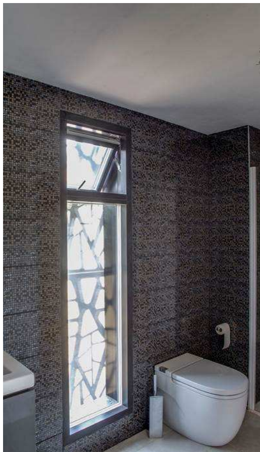
Foto 101. Ventana del baño sin vinilo
