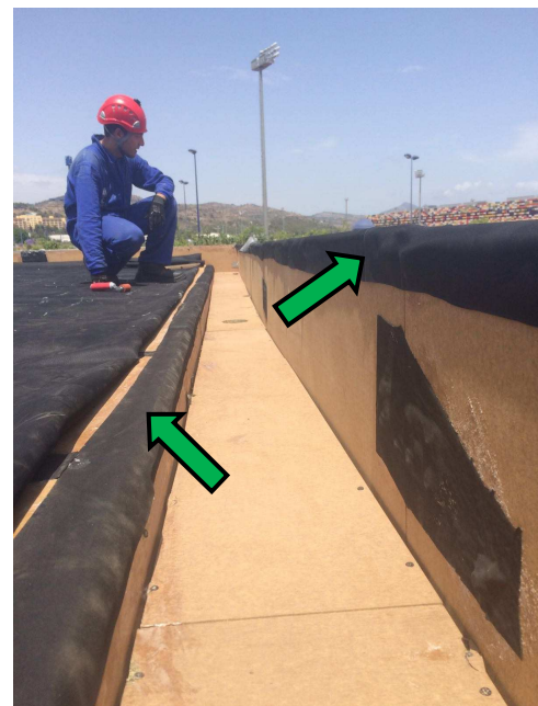
Foto 143. Refuerzo en cantos / [EP]
