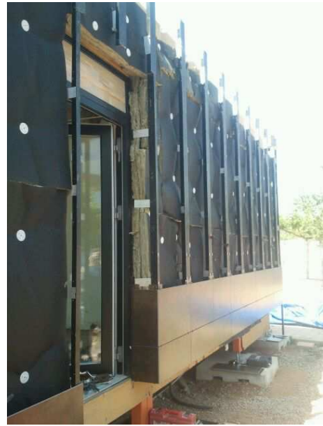
Foto 122. Aislante en cámara ventilada / [EP]
