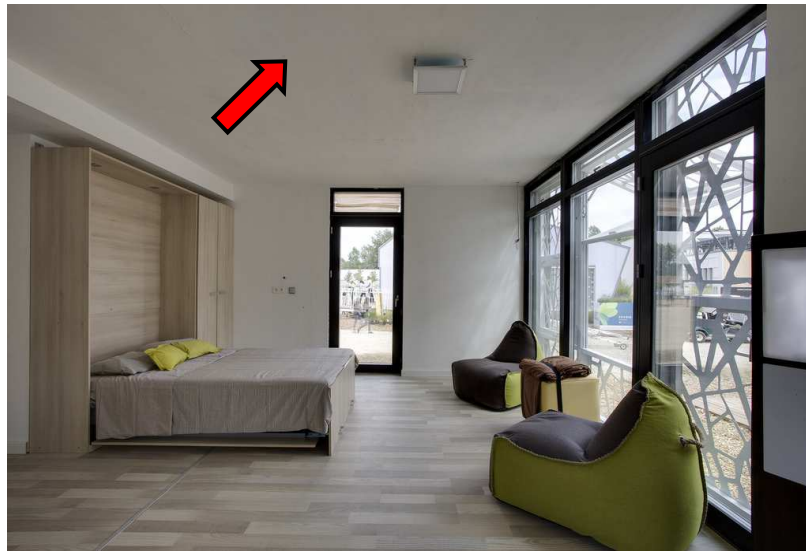
Foto 164. Falso techo continuo de placas de cartón-yeso éBRICKhouse 2014 / [equipe VIA-UJI]
