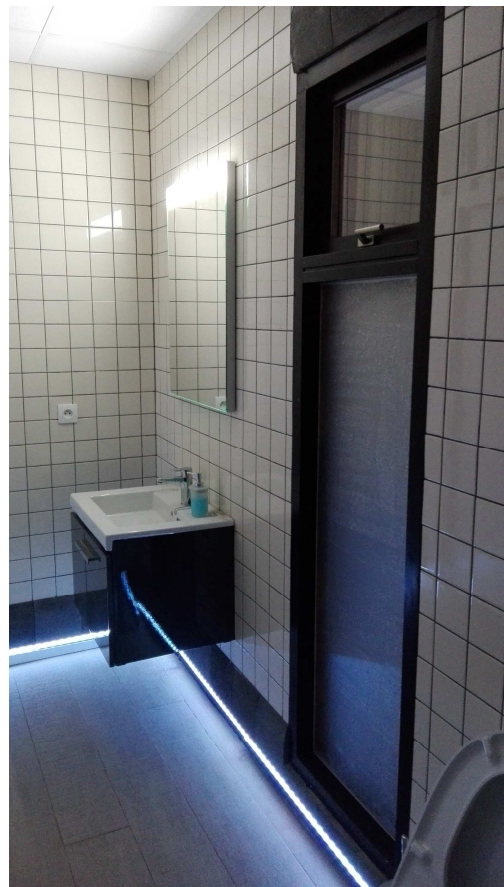
Foto 102. Ventana del baño con vinilo
