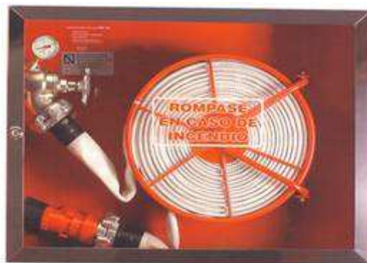
Fotografía 9. Boca de incendio equipda
