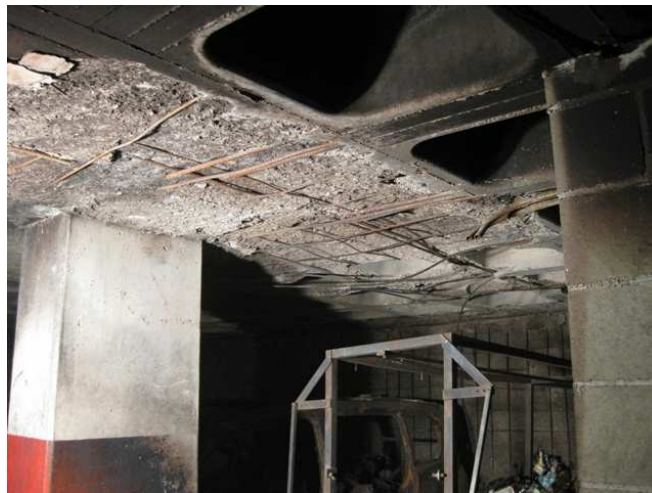
Fotografía 24. Forjado reticular después de un incendio
