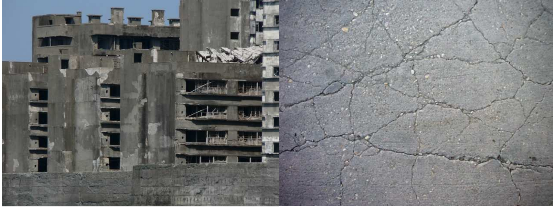
Fotografía 20. Resultado de incendio Fotografía 21. Fisuras superficiales del hormigón
