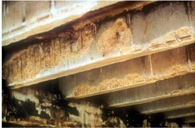
Fotografía 23. Vigas después de un incendio
