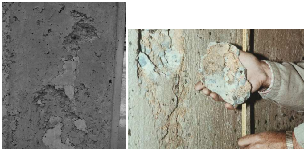
Fotografía 28. Coqueras en el hormigón
