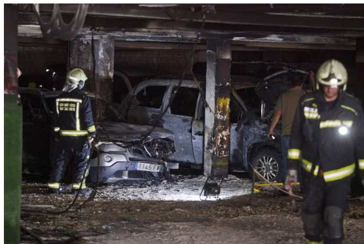
Fotografía 22. Pilar después de un incendio
