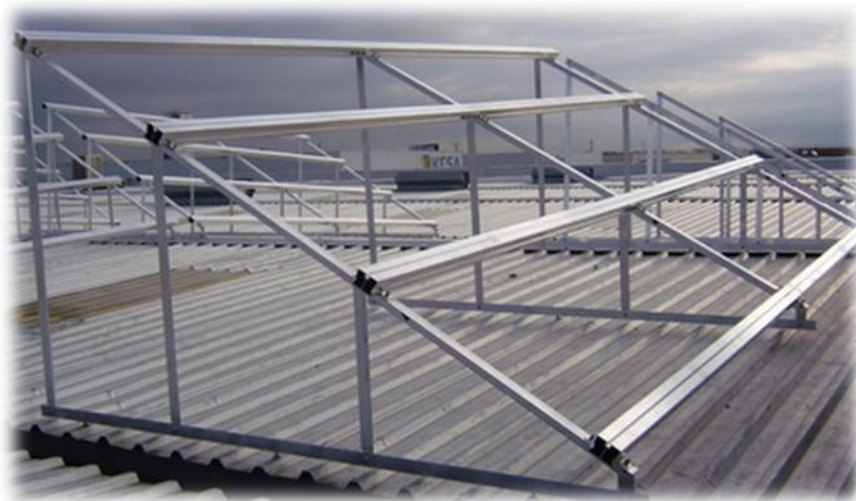
Ilustración XXI. Estructura fija anclada a cubierta
