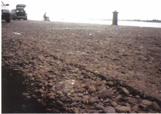
Hormigón en proceso de descomposición.
