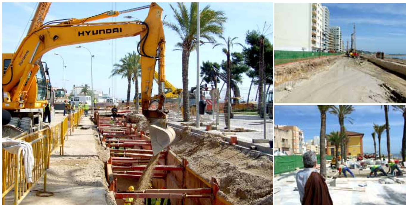
A Fora del Forat es treballa en la canalització de pluvials, mentre al passeig es fa el túnel subterrani i es posa el terra de la tercera fase
