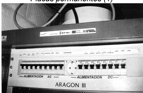
Etiquetas en los equipos instalados
