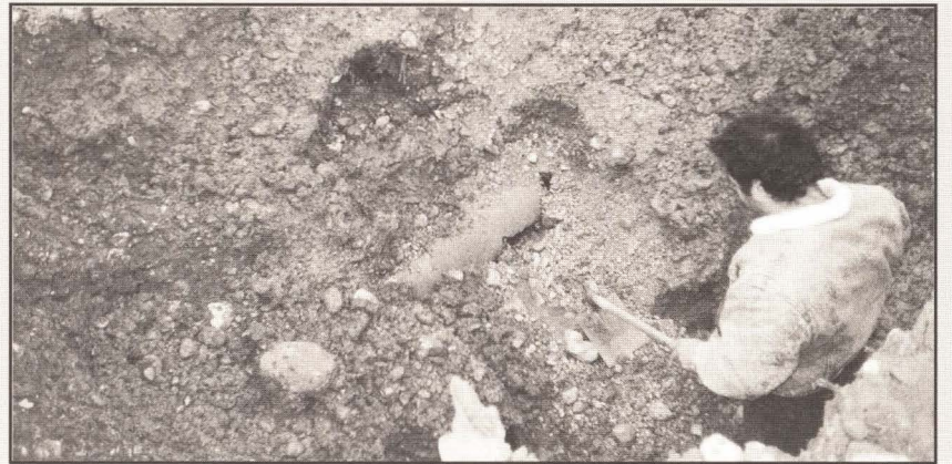
El viernes 5 de diciembre, nuevo reventón de la tubería "madre" que suministra el agua potable a Vinaròs. Foto: A. Alcázar
