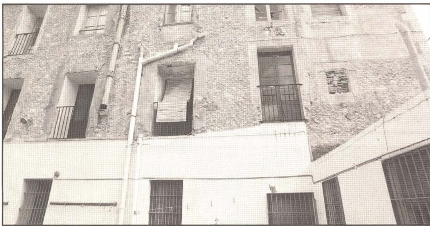
La estructura presenta grandes desperfectos desde hace años
