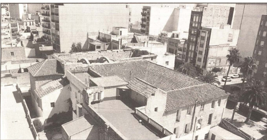
A raíz de la caída del techo una amplia zona del edificio conventual quedó afectada
