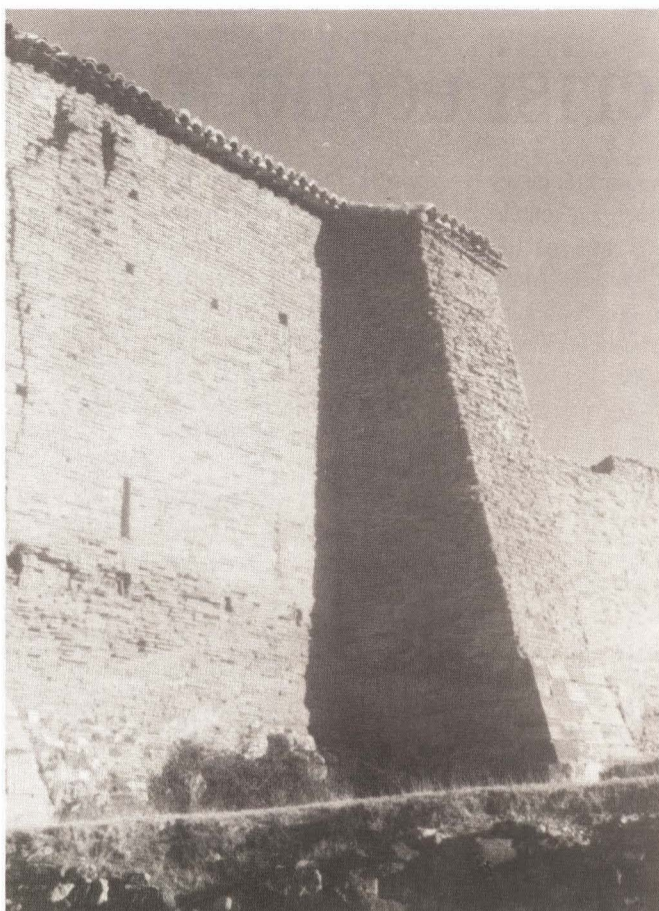
Muro a poniente del Castillo de Estercuel, con uno de los contrafuertes, en que se aprecia su base de sillares. A la izquierda (arriba) grietas del muro y (abajo) el contrafuerte de la foto anterior.
