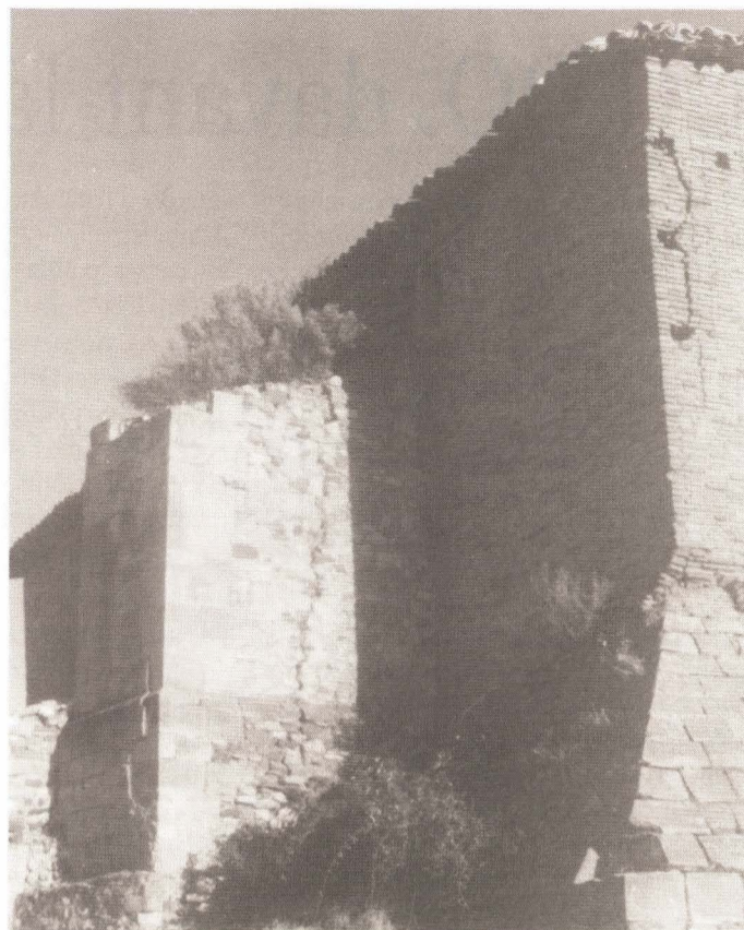
Parte septentrional del Castillo de los Atrossillo en Estercuel. Puede observarse el agrietamiento, tanto en el muro como en uno de los contrafuertes. Abajo, a la derecha, se aprecia la base de sillares, ataludada, que existe en todas las esquinas del Castillo.
