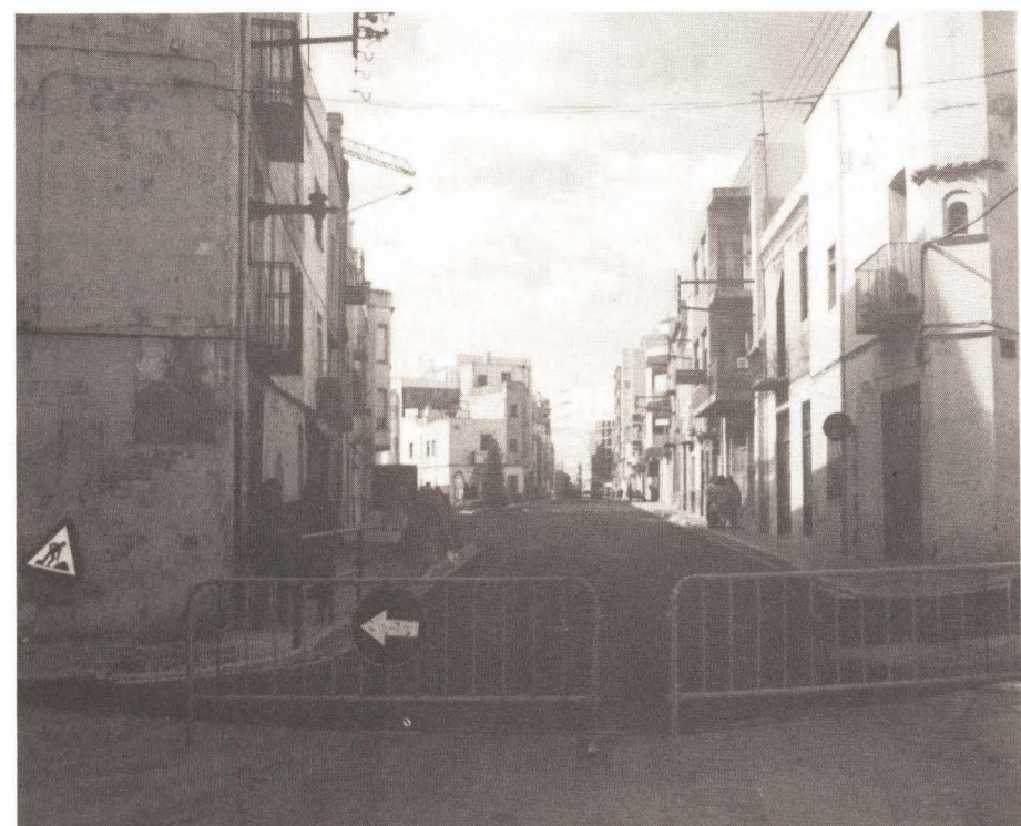
A falta de un tramo de acera en la que se está trabajando, la call del Puerto ha quedado completamente nueva. Foto: Reula
