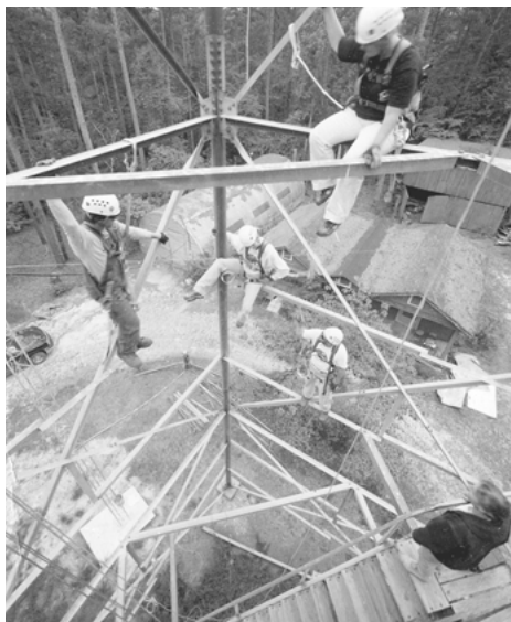
Foto 19. Construcció de la torre d'observació d'ocells del Perry Lakes Park a Marion, Alabama (foto gentilesa de l'Auburn University Rural Studio).
