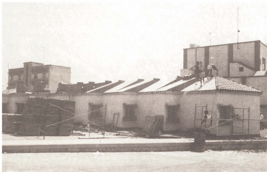
Se han remodelado y restaurado las casetas del puesto destinadas para almacenar los aparejos de pesca. Foto: Reula
