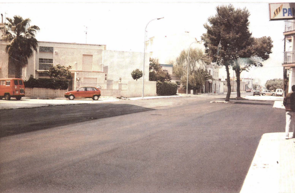
Han terminado las obras de pavimentación de la calzada Avda. Barcelona. Foto: Reula
