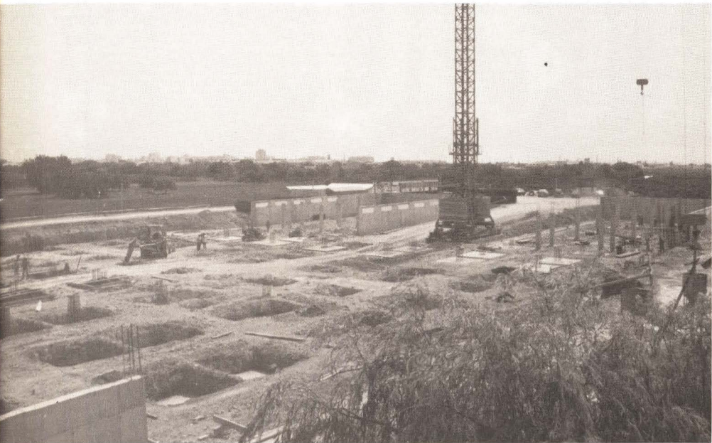
Se está en el proceso de cimentación y estructura. Foto: A. Alcázar
