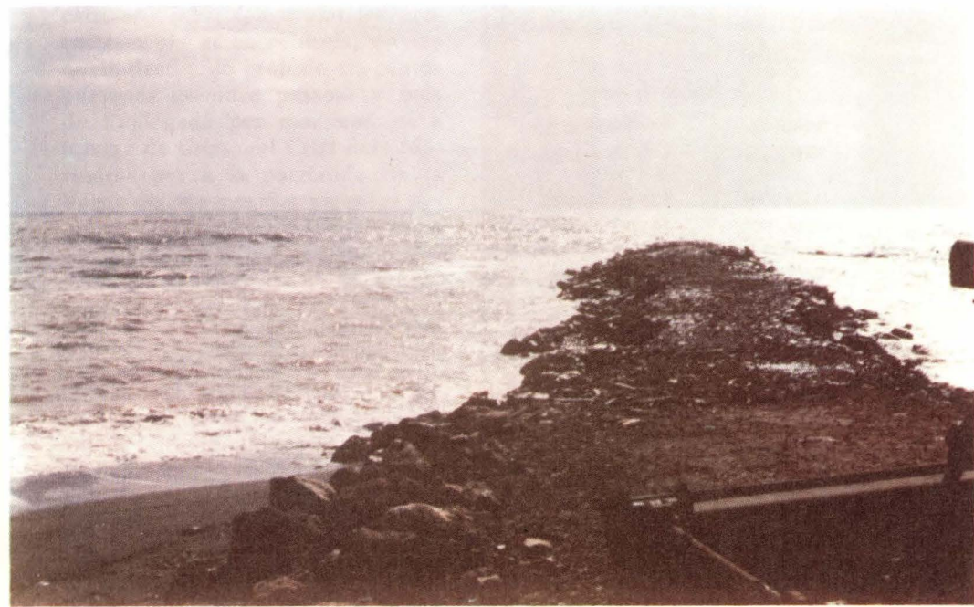
El nou dic en construcció, afectat pel temporal. Foto: A. Alcàzar
