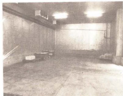
Cámara de refrigeración para pescados.
