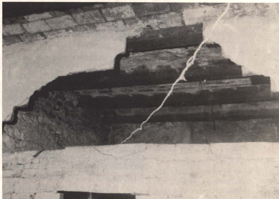
Estado ruinoso de una de las dependencias de la ERMITA
