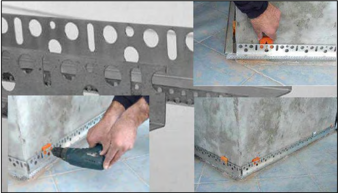
Figura 7.2 Fotos del proceso de colocación del perfil de arranque del sistema SATE (Aipex, 2013).
