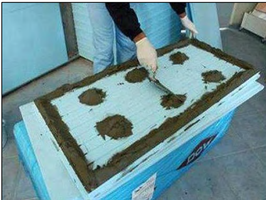
Figura 7.3 Foto del proceso de colocación las placas de XPS del sistema SATE (Aipex, 2013).
