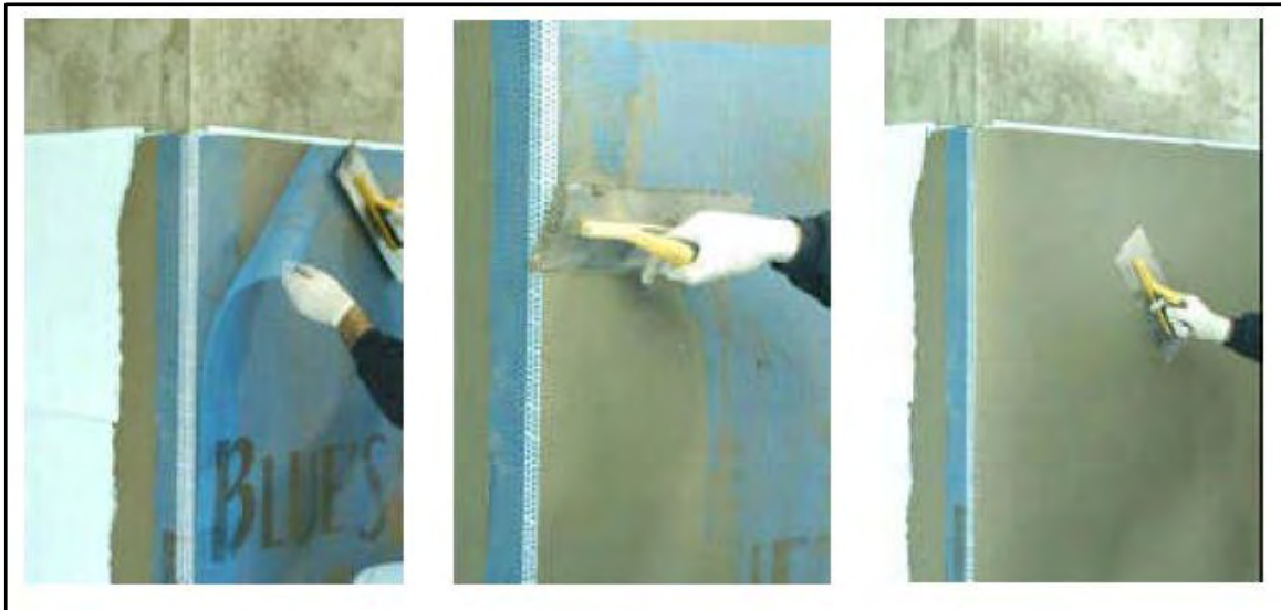
Figura 7.7 Fotos del proceso de colocación malla de armadura del sistema SATE (Aipex, 2013).
