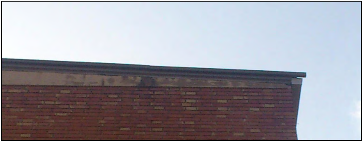
Figura 5.15 Patologías en cubierta, presencia de humedades. Informe ICE.
