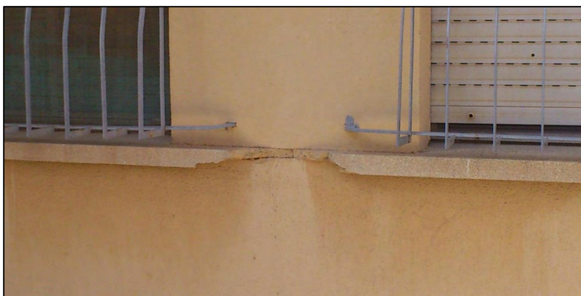
Figura 5.14 Patologías en fachada, desprendimiento de trozos del vierteaguas. Informe ICE.
