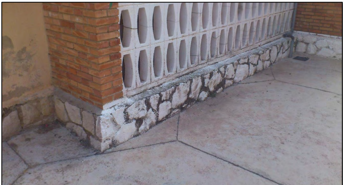
Figura 5.16 Patologías en fachada, presencia de humedades. Informe ICE.
