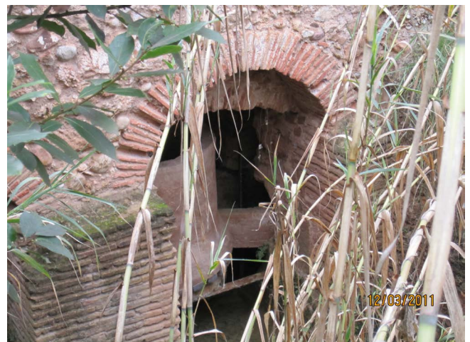
Figura 4. Detalle de un entrador de agua
