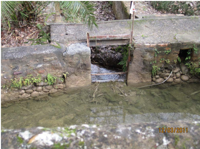
Figura 11. Entrador de agua
