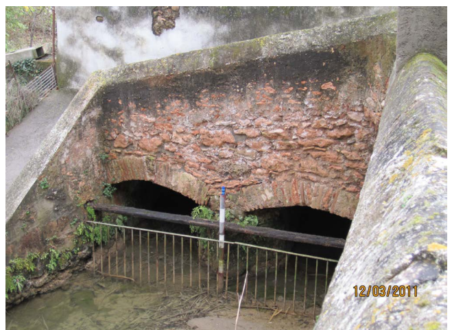
Figura 10. Frontal del medidor de agua
