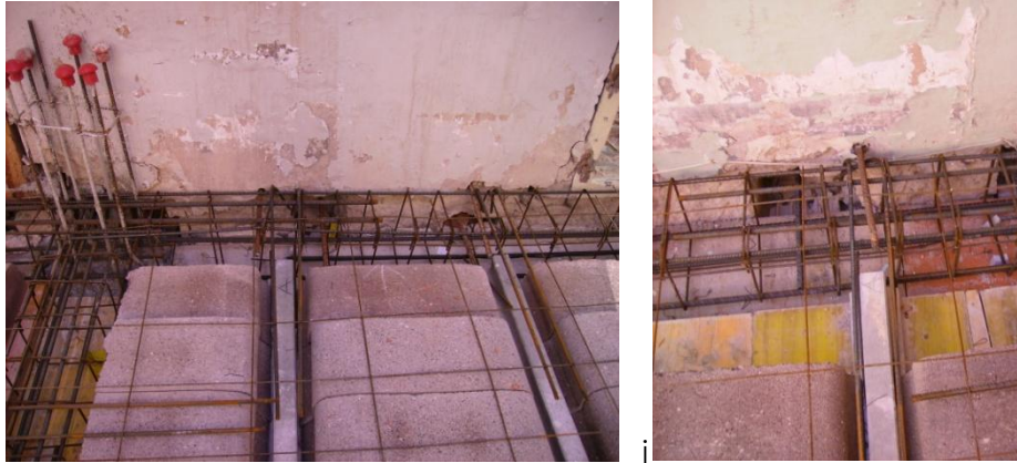
Fig.6.2.31 Forjado y barras de conexión entre el forjado y el muro de fachada. (Fuente: Lucas Blancas)
