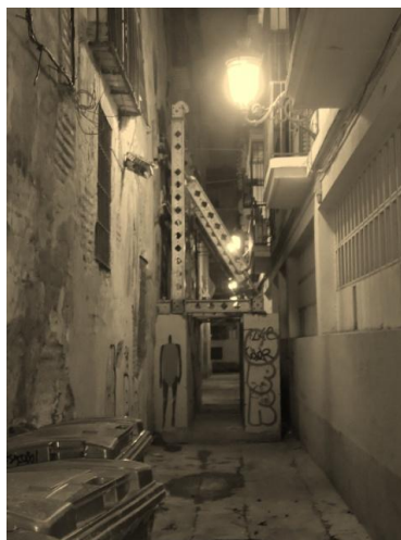
Fig. 4.61 Apeo industrial y contrafuertes de hormigón cortando el paso en c/Frigola (Valencia)
