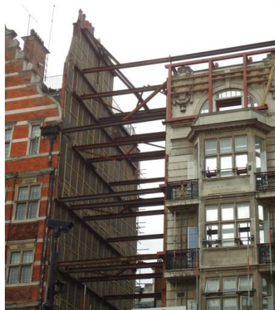
Fig.5.2.20 Perfecta adaptación del sistema de estabilización mediante perfilera metálica en inmueble de estilo victoriano en Londres.
