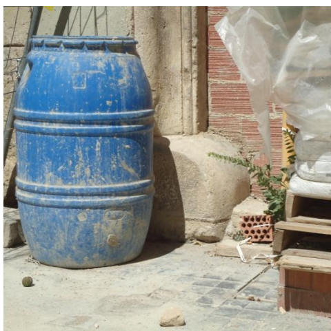
Fig.6.2.4 Guarda ruedas del recercado de la puerta de acceso, estado actual.
