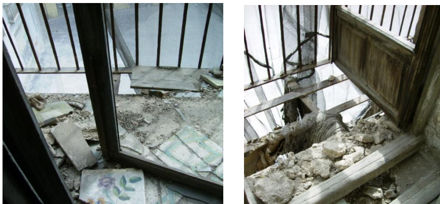
Fig.6.2.12 Estado previo balcones. (Fuente: Lucas Blancas)
