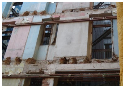
Fig. 4.62 Oquedades producidas por la retirada de las cabezas de viguetas en c/ Torn de L'Hospital (Valencia)
