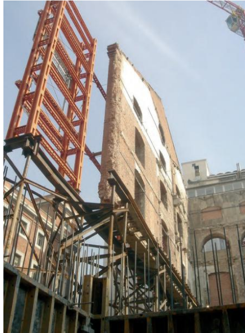
Fig.5.2.35 Torre estabilizador, sistema de micropilotaje arriostrado para conducir las cargas al nuevo estrato firme y aspecto interior del muro de fachada de la c/Gobernador (Jiménez Cañas & Bernabeu Larena, Caixaforum Madrid, 2008).
