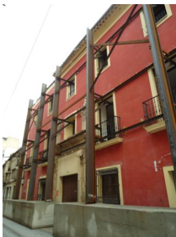
Fig.5.2.19 Sistema de estabilización resuelto mediante contrapeso de hormigón y perfilera de acero ubicado en la localidad Lorca para evitar el vuelco de la fachada debido al desplome de la misma tras el sismo.
