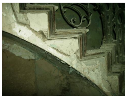
Fig.6.2.14 Grieta en losa de la escalera (Fuente: Lucas Blancas)
