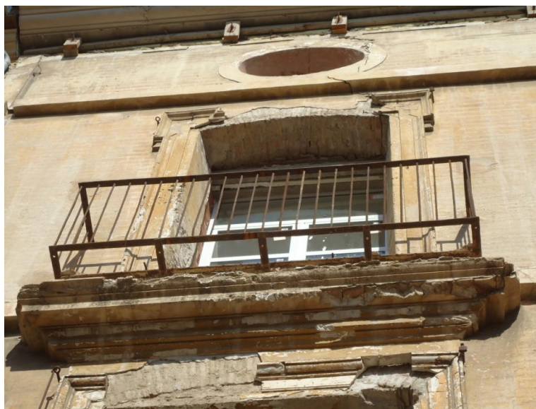
Fig.6.2.51 Estado del bajo-balcón y los recercados.
