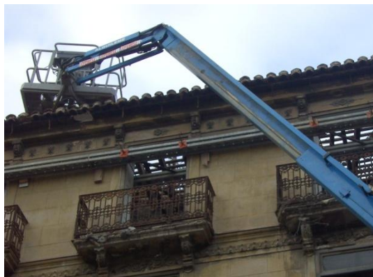
Fig.6.3.22 Plataforma elevadora articulada empleada en el desmontaje de cubierta (Fuente: Lucas Blancas)
