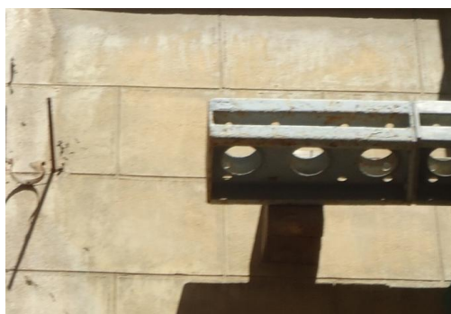
Fig. 4.32 Revoco a la catalana de acabado liso con plinto a modo de imitación de sillería (Barahona, 2000) en fachada del edificio situado Plaza árbol Valencia
