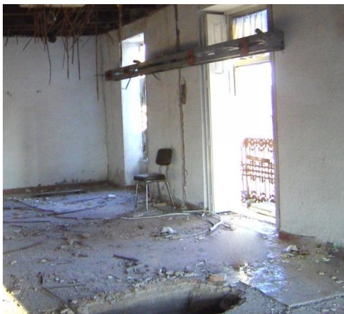
Fig. 6.3.20 Agujero practicado entre el entrevigado con el fin de evacuar los residuos por tal punto. (Fuente: Lucas Blancas)
