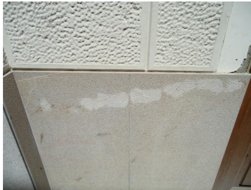
Fig.4.26 Aplacado en el zócalo del edificio de la c/Santo Tomas (Valencia) a modo de imitación del aplacado original que existía antes de la actuación.
