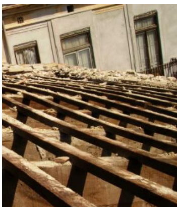
Fig.6.2.24 Viguetas y rastreles de la cubierta al descubierto tras la retirada de las tejas y los bardos. (Fuente: Lucas Blancas)
