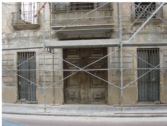
Fig.4.31 Revoco a catalana de acabado liso donde se ha despiezado su superficie con la ayuda de llaguero en la parte superior al zócalo de la planta baja, antes de la actuación en el edificio c/ Cami Real. (Fuente: Rosa Lapiedra Alcamí)
