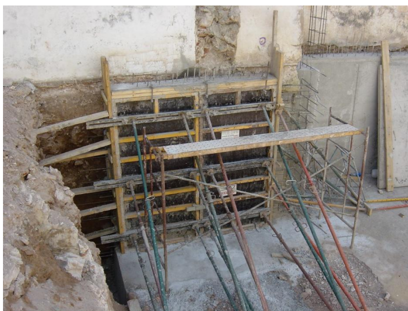
Fig.6.1.13 Hormigonado del muro de contención en la zona adyacente a la medianera donde puede verse el encofrado empleado. (Fuente: Rosa Lapiedra Alcamí)
