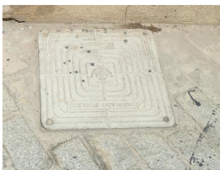
Fig. 6.3.16 Instalación municipal suministro de luz situada en paralelo al acceso de la obra tapiado.
