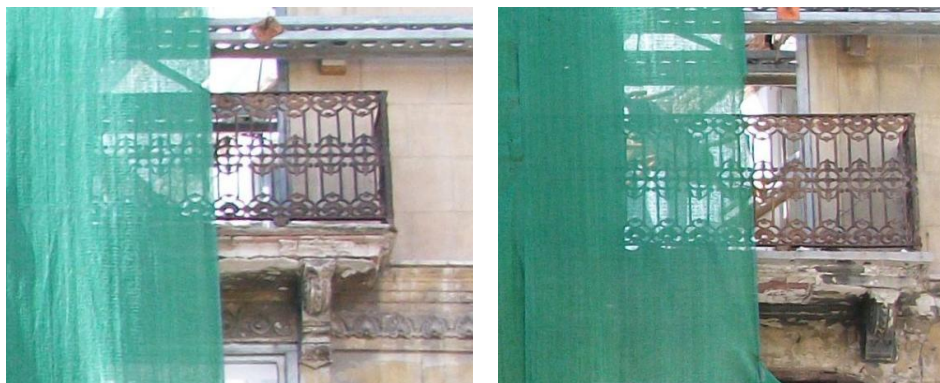
Fig.6.3.31 Estado de dos de los balcones que se han podido observar. (Fuente: Lucas Blancas)
