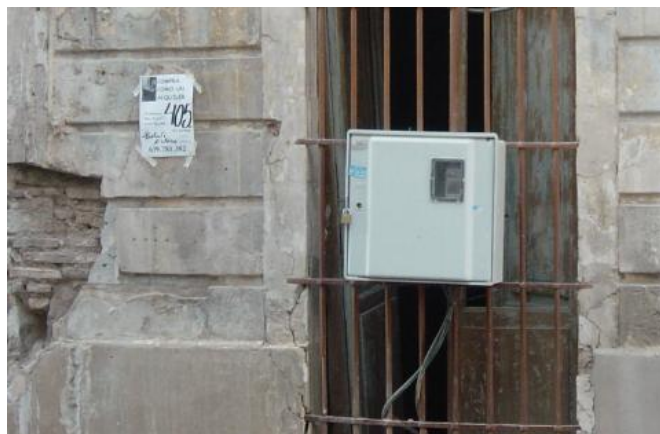
Fig.6.1.6 Rotura y desprendimiento del revoco de planta baja y fisuras en el recercado del vano. (Fuente: Rosa Lapiedra Alcamí)
