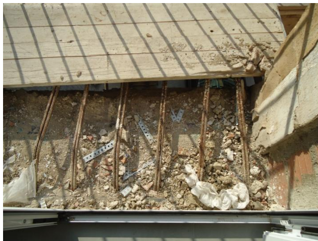
Fig.6.2.33 Estado del balcón durante la visita realizada a obra.
