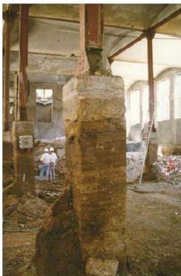
Fig.4.14 Zapatas aisladas descubiertas durante el rebaje a la cota de cimentación realizado en el actual Caixa Fòrum - Barcelona. (Fuente: David Lladó i Porta).
