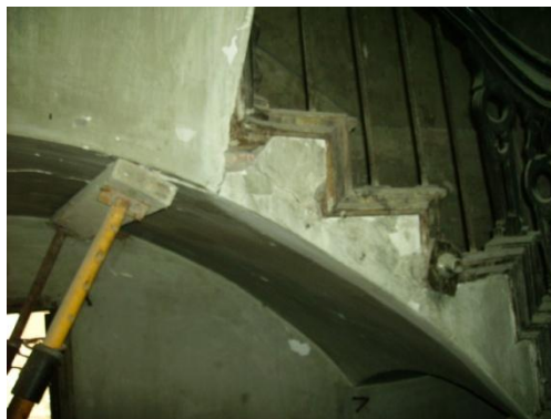
Fig.6.2.15 Fisura no coplanaria en la bóveda de la escalera a la catalana que preciso de apuntalamiento. (Fuente: Lucas Blancas)
