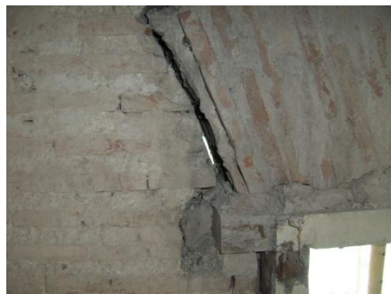
Fig.6.2.43 Grieta en uno de los vanos. (Fuente: Lucas Blancas)
