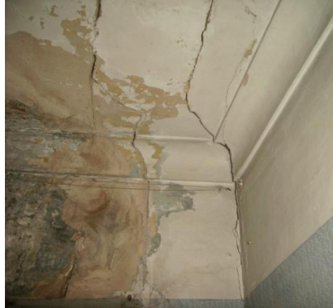
Fig.6.2.8 Humedades y fisuras en el paramento y techo de una de las habitaciones. (Fuente: Lucas Blancas)
