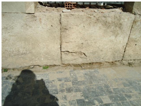
Fig.6.2.17 Meteorización superficial de los mampuestos del zócalo de la fachada conservada.
