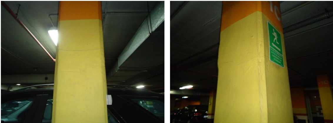
Fig.5.2.27 Fisuras horizontales ubicadas en los pilares de la planta del primer sótano.
