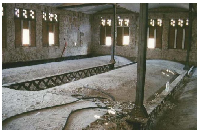
Fig.4.8 Vista de las bóvedas y vigas interiores durante el desmontaje para colocar los refuerzos. (Fuente: David Lladó i Porta)
