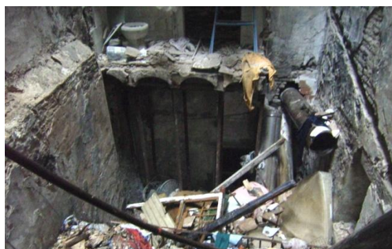
Fig. 6.3.7 Residuos acumulados en el patio de luces. (Fuente: Lucas Blancas)
