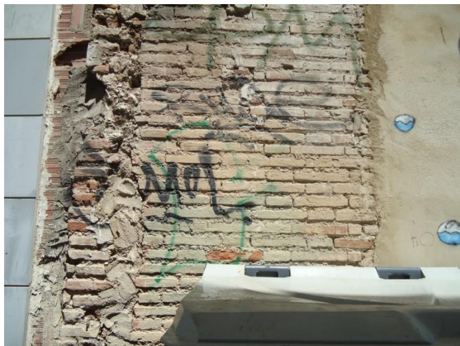
Fig.6.3.6 Parte inferior del muro descubierta en su totalidad en la fachada principal.
