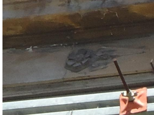
Fig.6.3.33 Muestra de la ausencia de elemento decorativo que se han desprendido, pues en el resto de la coronación de los huecos de la planta tercera se encuentra el rosetón rodeado simétricamente por dos dagas.
