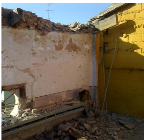
Fig.6.2.36 Vista del muro por el interior tras la retirada de la cabeza de la vigueta de la anterior estructura de cubierta. (Fuente: Lucas Blancas)
