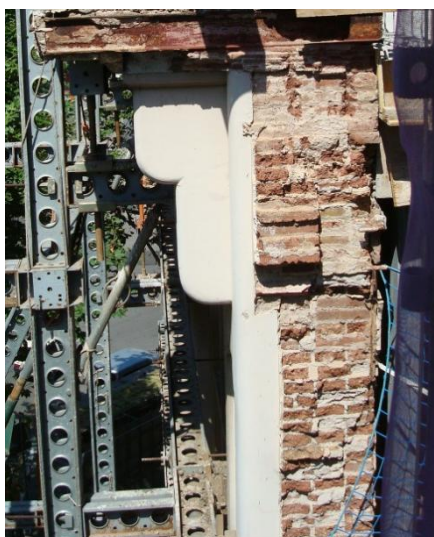
Fig. 4.25 Muro simple de fábrica de ladrillo de aproximadamente 50cm de espesor (Fuente: García-Borés i Ruano Arquitectes, SLP).
