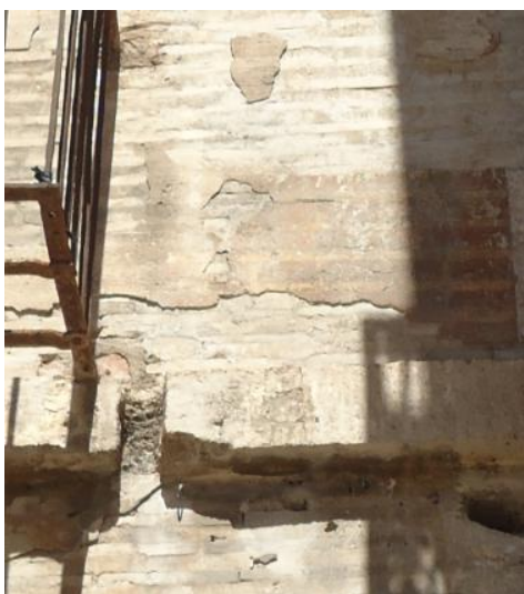
Fig.6.2.6 Revoco del paramento y pérdida del mismo en otros puntos.
