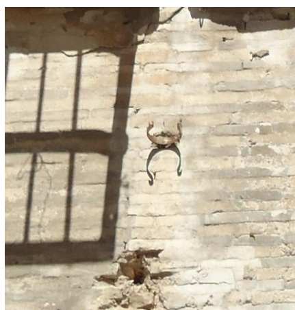
Fig.6.2.16 Fractura del muro debida a la corrosión de un gancho de hierro embebido como el situado en su parte superior que se presenta oxidado.
