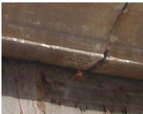
Fig.6.2.7 Colocación de un objeto clavado en la carpintería de la puerta principal para comprobar si se producen movimientos del mampuesto que compone el dintel. (Fuente: Lucas Blancas)
