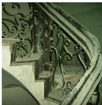
Fig.6.2.13 Pudrición en pasamanos barandilla escalera (Fuente: Lucas Blancas)
