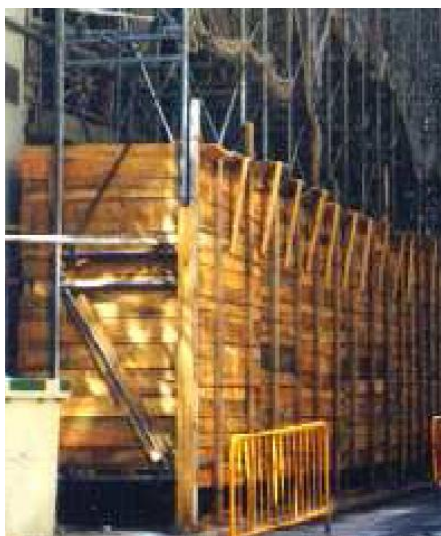
Fig.6.1.11 Contrapesos de otra obra formados por cajón de madera relleno de grava. (Fuente: Cimbra Andamios)
