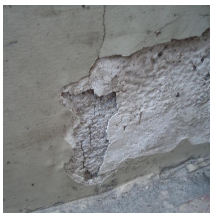
Fig. 4.21 Zócalo fachada Edificio Hidrola donde tras la pérdida del revestimiento debido a procesos de deterioro tanto por los agentes biodegradables como por la humedad puede observarse el material que conforma el muro de fachada.
