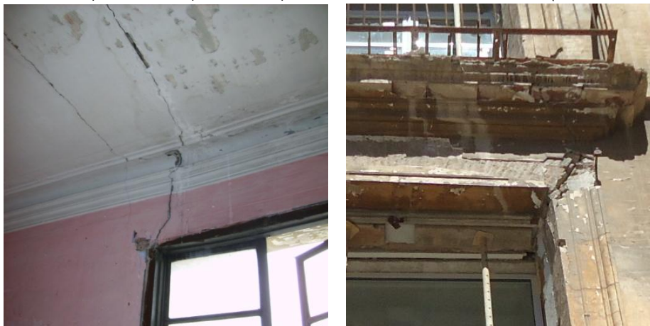
Fig 6.2.9 y 6.2.10 Grietas que nacen de forma ascendentes desde las esquinas de los vanos. En la figura de la derecha se puede ver dicha lesión en uno de los vanos en su estado previo (Fuente:Lucas Blancas) y a la izquierda se observa la lesión en otro vano en la actualidad.
