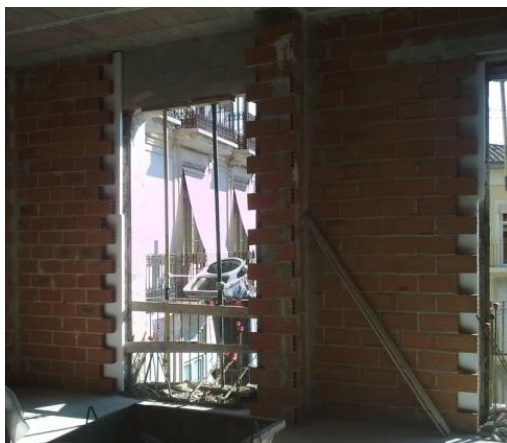
Fig.6.2.47 Solución mencionada empleada en algunos de los vanos. (Fuente: Lucas Blancas)
