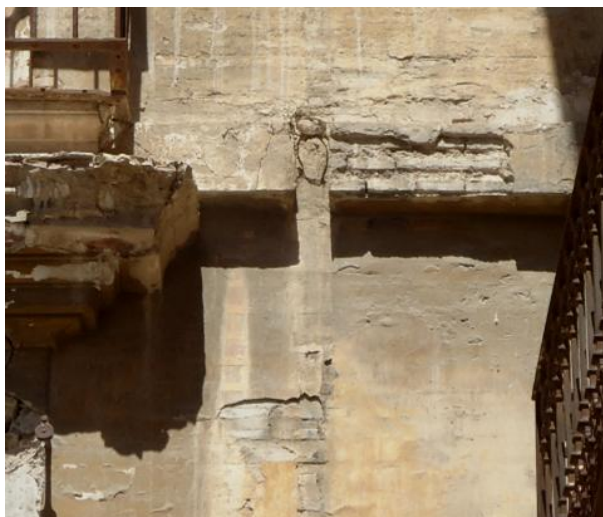
Fig.6.2.5 Desprendimiento del revestimiento de la imposta.
