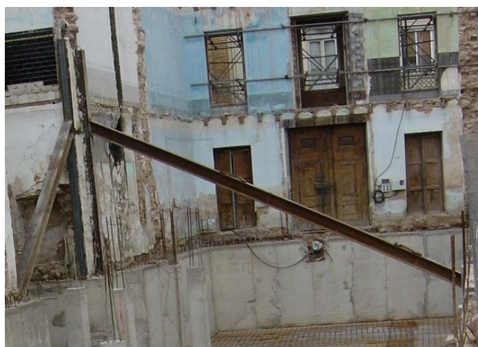
Fig.6.1.8 Fotografía de la fachada estabilizada desde el interior donde se observan las barras tubulares adyacentes, choca la atención los perfiles de acero que se emplearon como apuntalamiento tras la aparición de unas fisuras en la medianera. (Fuente: Rosa Lapiedra Alcamí)
