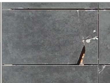
Rotura en fachada ventilada
