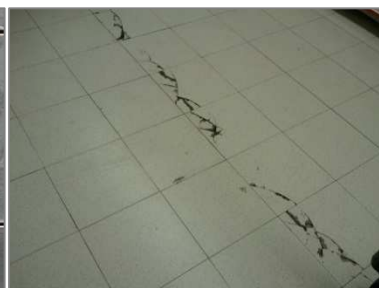
Aparición de fisuras
