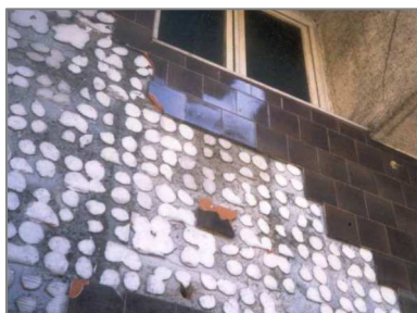
Desprendimiento de aplacado
