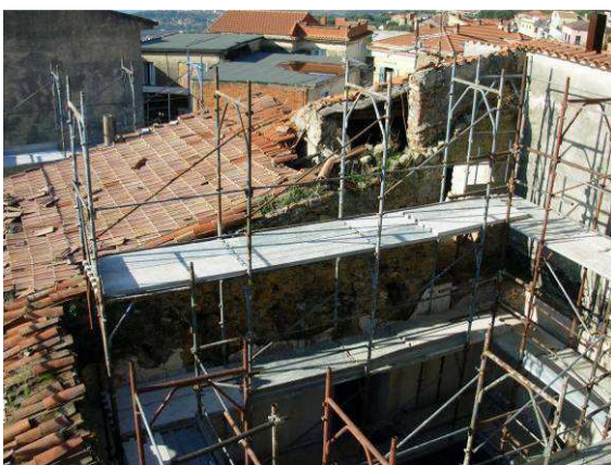
Imagen del andamio que se ha montado para los trabajos de consolidación de los muros en la parte derrumbada
