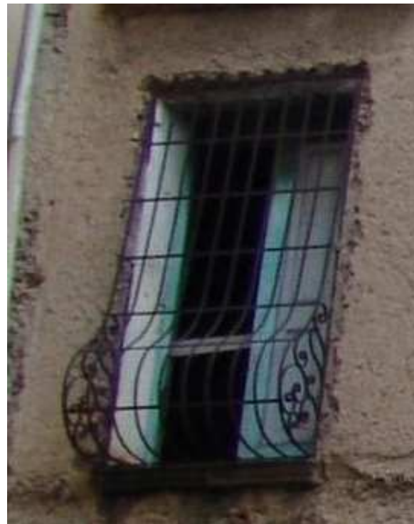
Reja que no guarda ningún parecido con las demás y que seguramente fue instalada durante algunas de las reformas que ha tenido el edificio
