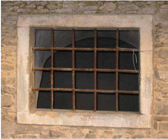
Ejemplo de una reja oxidada, al igual que todas las que nos encontramos en el edificio
