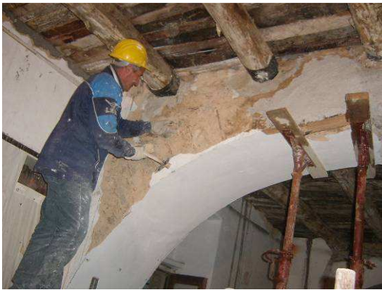
Trabajo manual y con cautela de eliminación de la capa de mortero del arco
