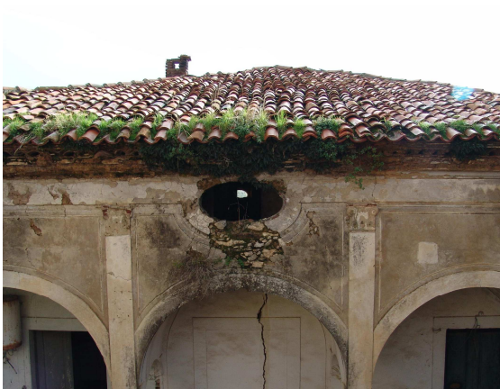
Detalle de la grieta producida por el terremoto de 1980
