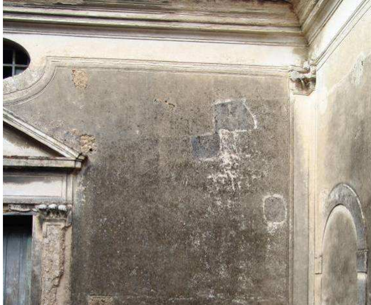
Fachada interna del patio, para solucionar esta patología se procederá al pintado del paramento
