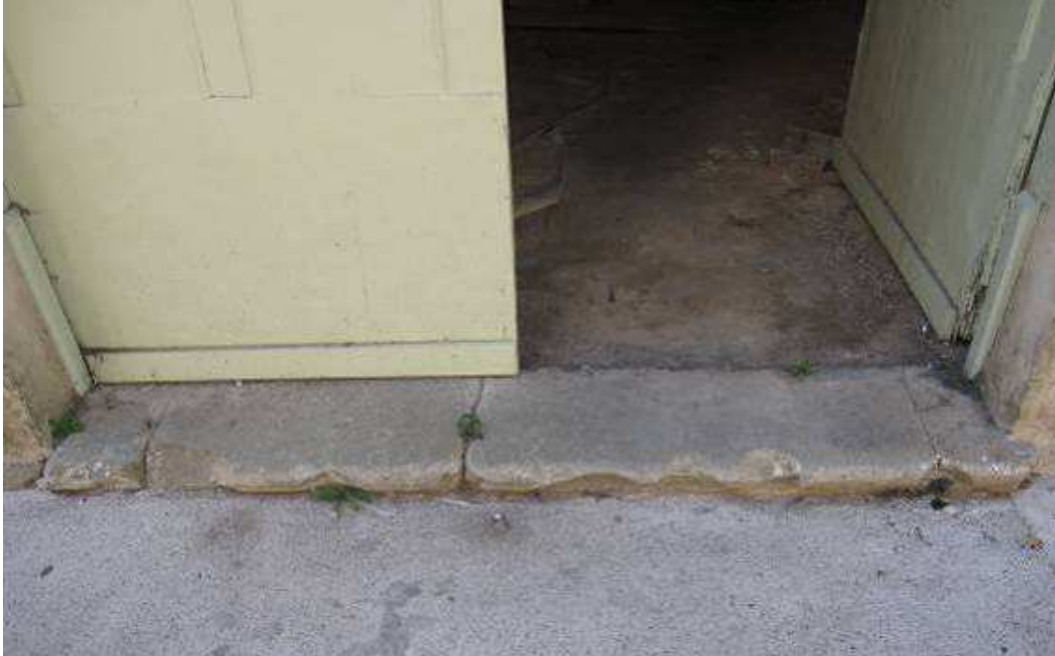
En esta imagen se aprecia el umbral de una puerta degradado por el uso y el paso del tiempo
