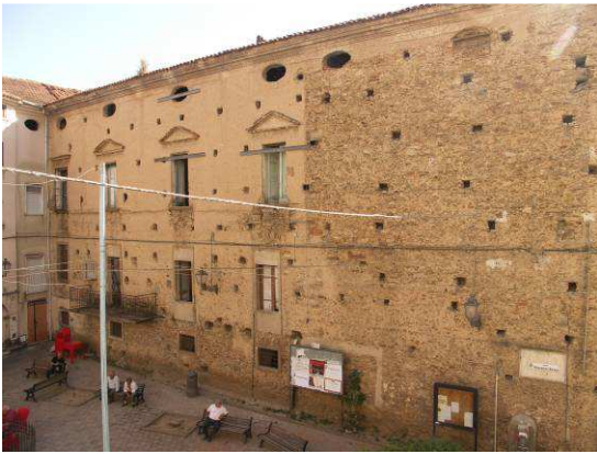
Vista de la fachada con los tirantes antes del inicio de los trabajos de restauración
