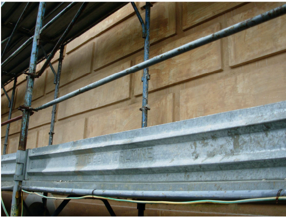
Detalle de la imitación de sillares en las fachadas entre la planta baja y la primera
