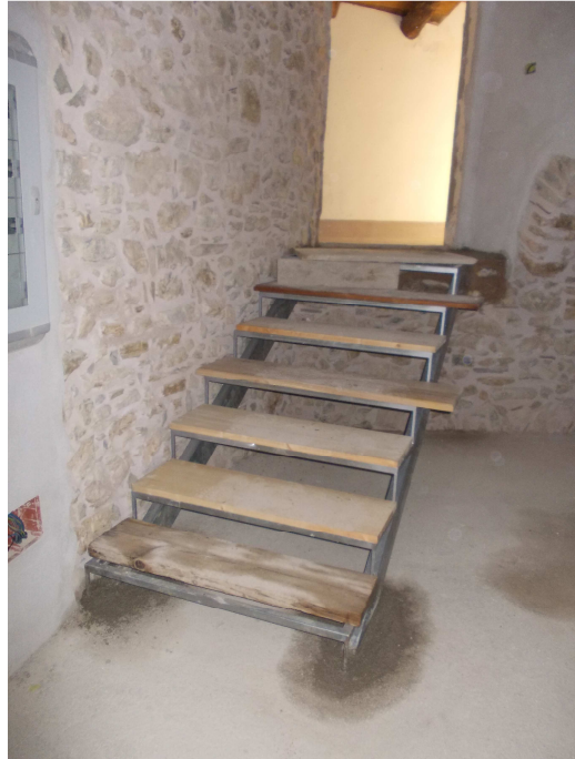
Escalera que comunica las dos alas del edificio en planta bajo cubierta, en frente se encuentra el ascensor.
