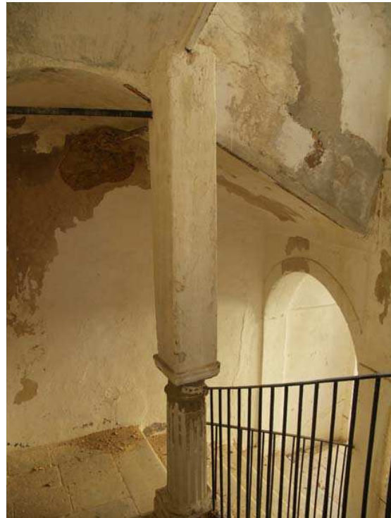
Imagen del pilar construido en una época posterior a la construcción del edificio, con la función de reforzar la estructura y soportar las cargas
