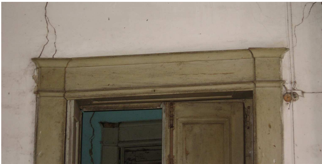
En este caso podemos ver una rotación del dintel de la puerta, en este caso se sustituirá el dintel de la puerta y se reforzará el muro
