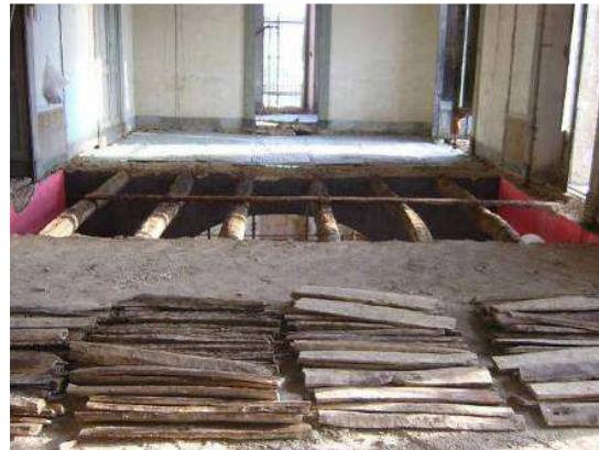
A continuación se colocan las tablas sobre las vigas unidas a estas mediante grapas
