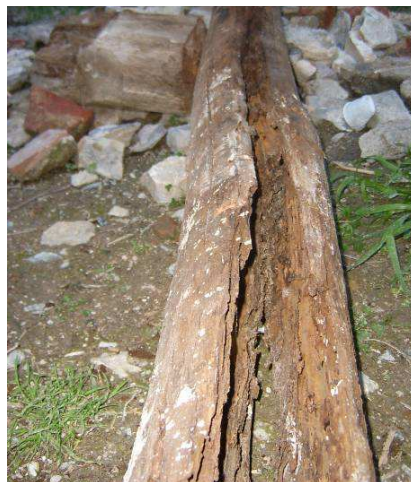
Viga de madera afectada por el ataque de xilófagos
