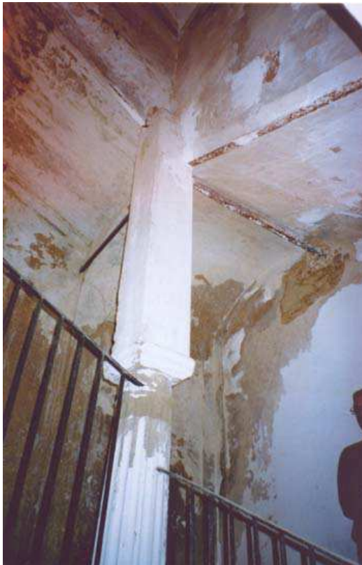
Imagen de los perfiles metálicos para soporte de cargas, supuestamente insertados en la misma época en que se realizaron los pilares
