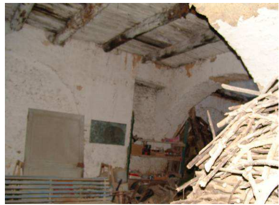
Forjado de madera pintado y en un estado bastante deteriorado
