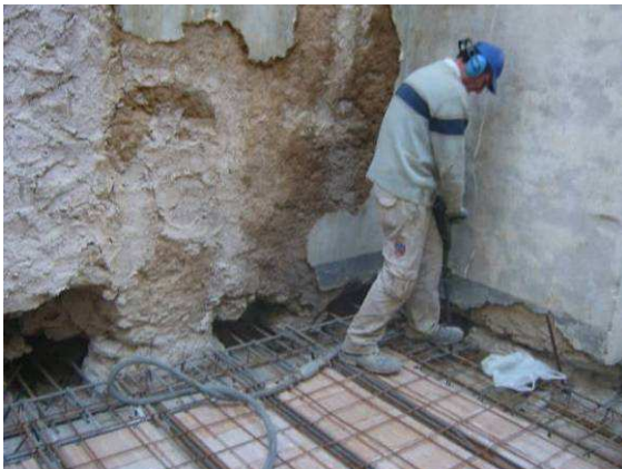
Operario realizando la inserción de conectores para mantener el forjado y el muro unidos
