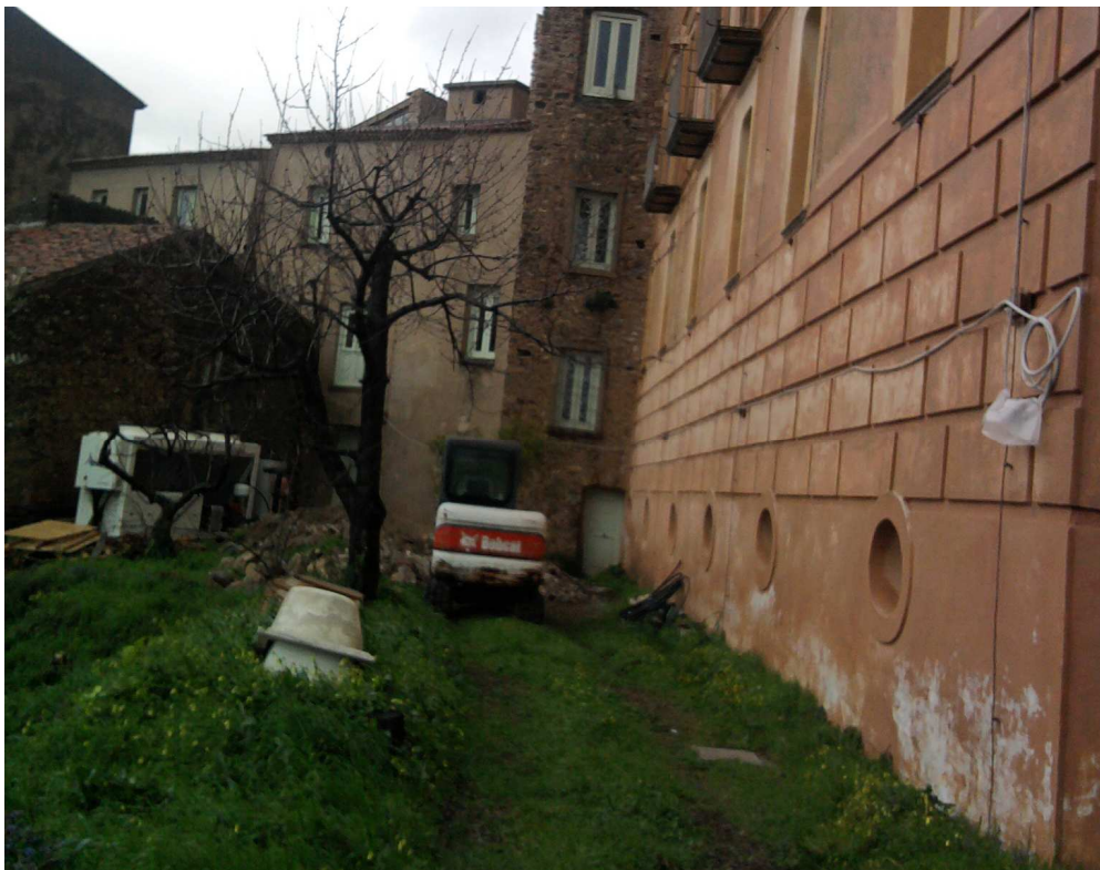
Nos encontramos eflorescencias en la fachada de calle Rizzi, estas aparecieron una vez finalizada su restauración
