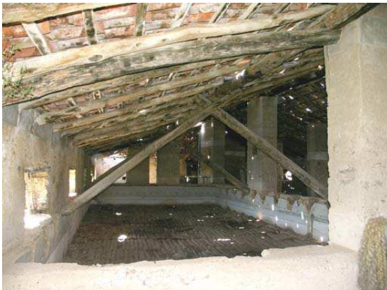
Imagen general de la cubierta, en la que se ve el forjado de la planta inferior correspondiente a la sala noble se será elevado conforme a su estado original.
