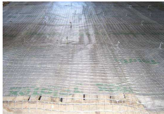
Se insertan los conectores que unirán la estructura de madera con la capa de compresión y otros conectores que unirán los muros perimetrales también con la capa de compresión (que no se ven en la imagen pero sí en el detalle constructivo) y a continuación se extiende una malla plástica
