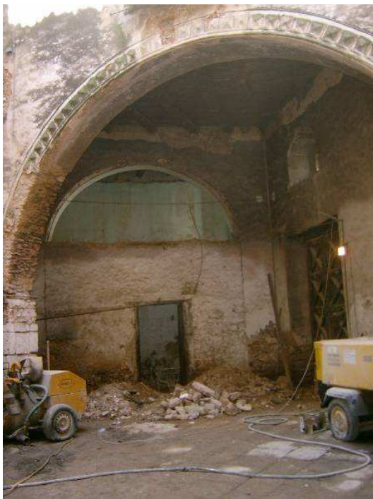
Arco que da paso al patio central del edificio, con un arranque de sillares regulares y continuación de piedras planas que forman el arco
