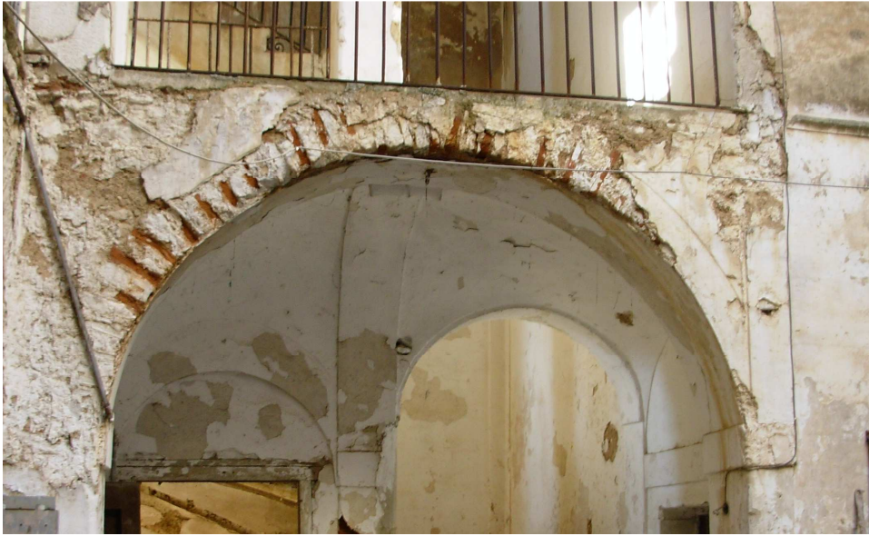
Erosión de los ladrillos que forman el arco de la bóveda que da paso a la escalera central
