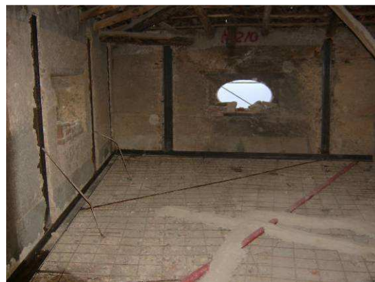
Colocación de la malla electrosoldada, los perfiles verticales y horizontales en todo el perímetro de la cubierta y barras para la estabilidad de los perfiles
