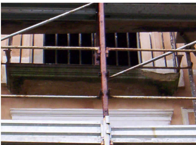
Detalle de la base de un balcón con una esquina rota
