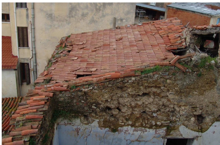
Imagen del desplazamiento de las tejas, esto provoca la entrada de agua en el interior y es el desencadenante de la aparición de otras patologías como la pudrición de las vigas, la aparición de humedades en la paredes, etc.
