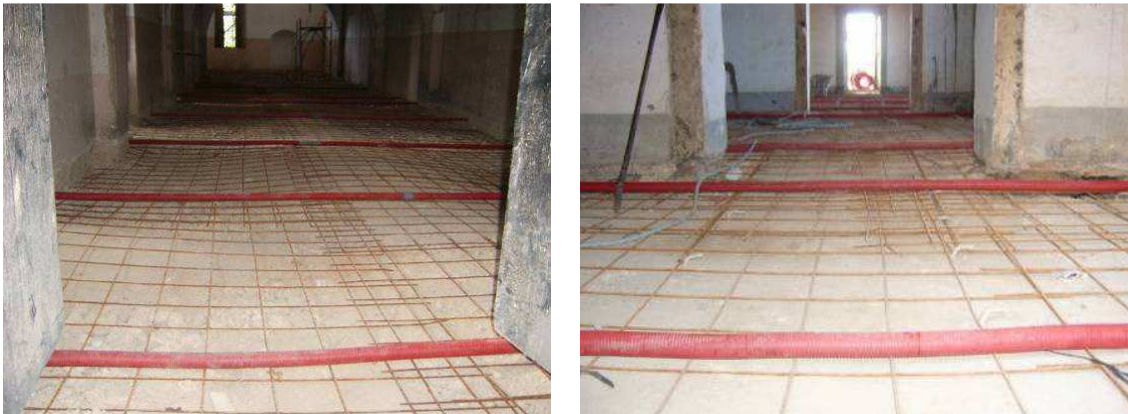
Imágenes de los tirantes ya colocados en obra y recubiertos por tubos
