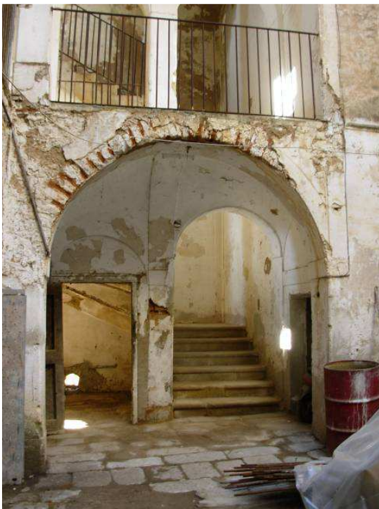
Arco de acceso a la escalera de estilo "settecentesco" realizado a base de ladrillos macizos desde su base decorada imitando a un pilar
