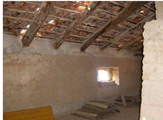
Aquí se aprecia como la cubierta apoya en una especie de zuncho perimetral
