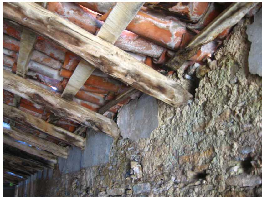
Aquí vemos como el material de enlucido se ha desprendido del muro
