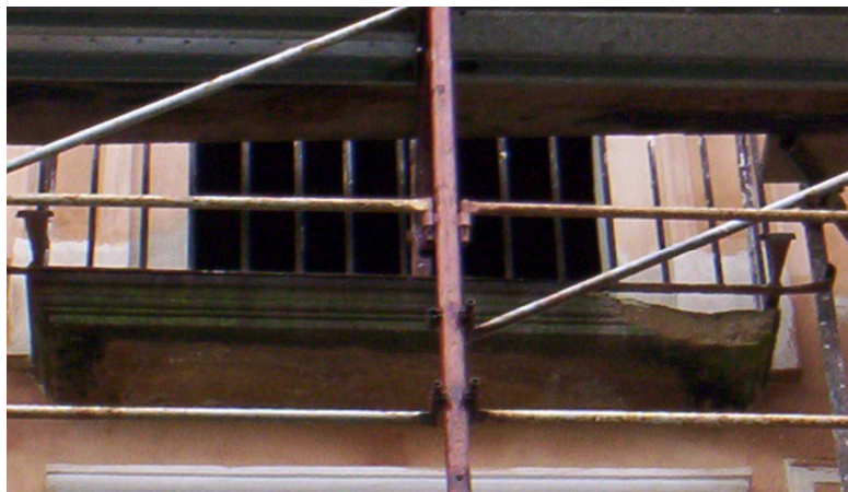
Pérdida de una parte de la piedra que forma la base de uno de los balcones situados en la fachada de la calle Rizzi, para su solución está previsto el cambio entero de la pieza
