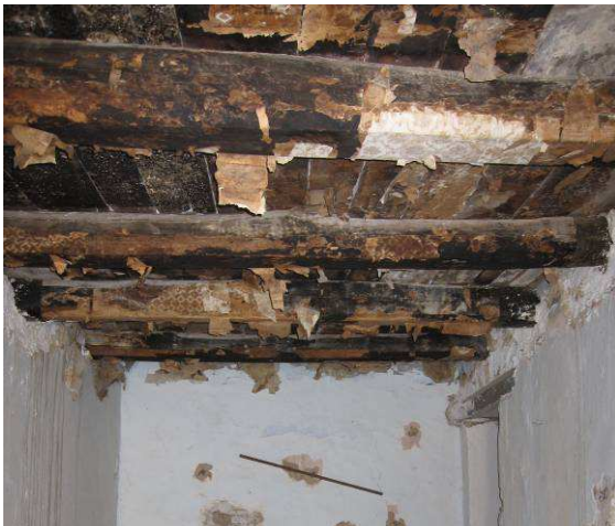
Forjado de madera en cual estaba recubierto por papel ahora ya muy deteriorado
