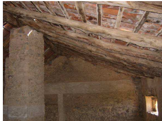
Imagen del bajo cubierta donde vemos todos los elementos que componen el armazón de la cubierta como son: la cumbra, los cabrios, las correas, el muro piñón al fondo, el muro de fachada a la derecha y uno de los soportes sobre el que apoya la cumbra
