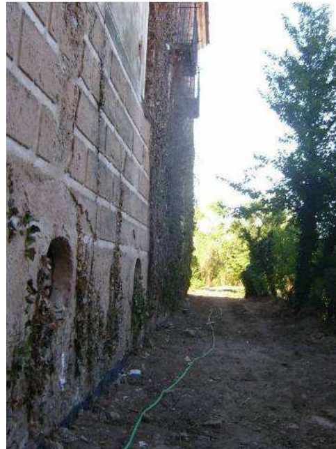
Aparición de organismos de origen vegetal entre las justas del pavimento del patio y en la fachada de calle Rizzi
