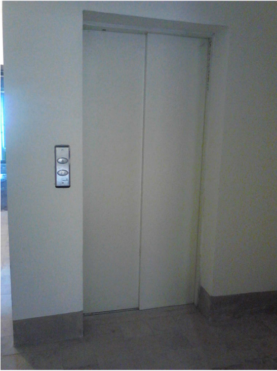
Ascensor ya instalado
