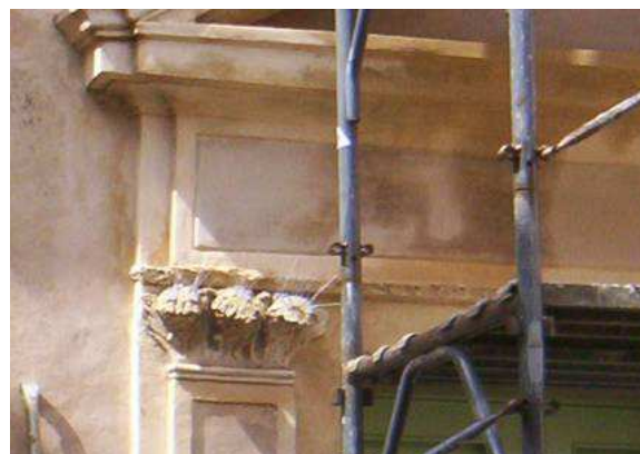
Detalle de las hojas de acanto que decoran los capiteles de las pilastras de la balconera que hay en la fachada de entrada al patio
