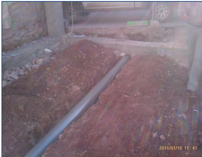
Fig. nº30: Tubería principal de la red de saneamiento enterrada.
