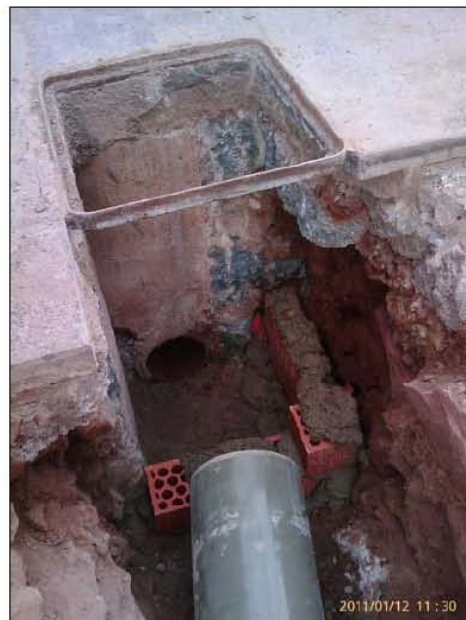
FASE | INSTALACIONES - Ampliación de la arqueta final de la red de saneamiento.
