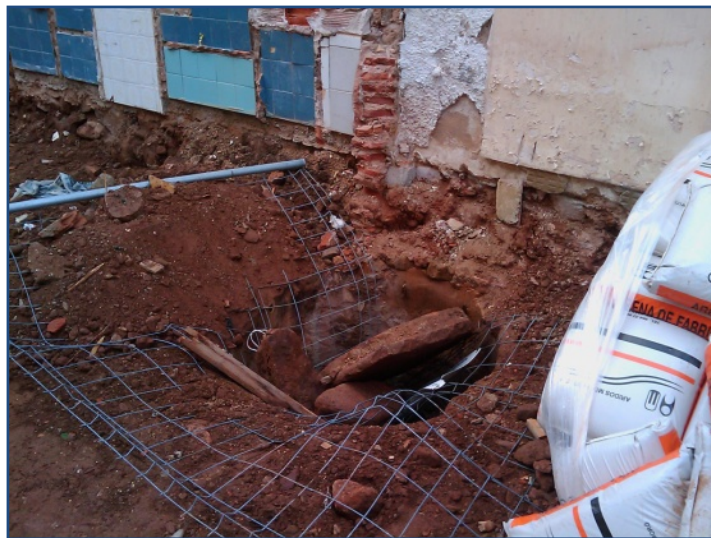
Fig. nº14: Protección en pozo profundo.
