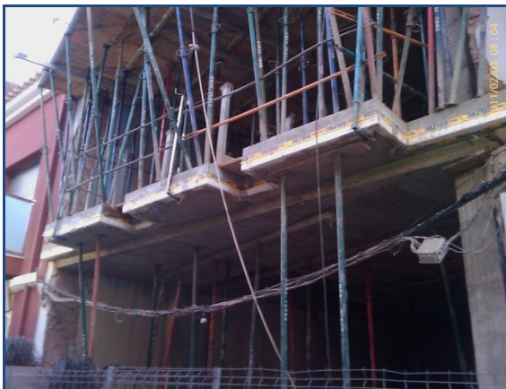
Fig. nº28: Barandilla de seguridad.
