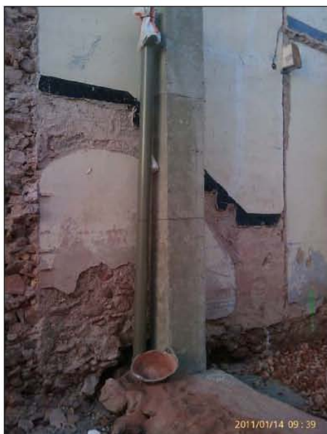
FASE INSTALACIONES - Instalación de bajantes, las cuales conectan directamente con la tubería principal de la red de saneamiento.
