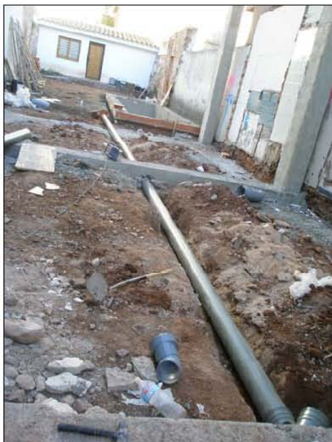
FASE | INSTALACIONES - Instalación de la tubería principal de la red de saneamiento.
