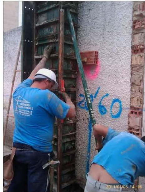
FASE | ESTRUCTURAS - Aplomado de los pilares posterior al hormigonado apuntalándolos para mantener la verticalidad.
