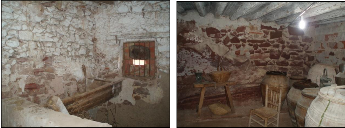
Imágenes 53 y 54. Paredes sótano, corral y habitación de aperos.
