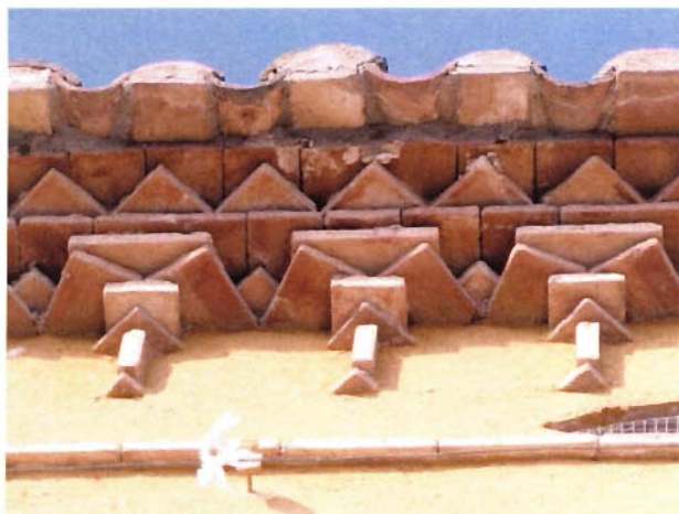
Foto 7: Ràfec de les dos façanes de les Escoles de la Montalba.
