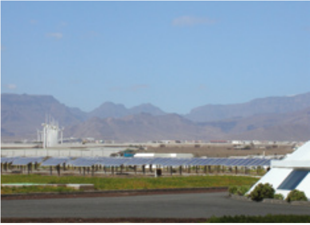
Paneles de energía fotovoltaica en las instalaciones del ITC en Pozo Izquierdo (Gran Canaria).
