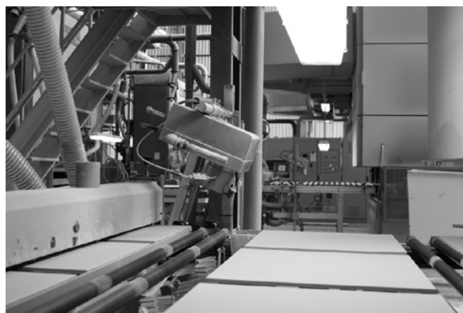
Figura 3. Sensores de humedad instalados a la salida de dos prensas industriales.
