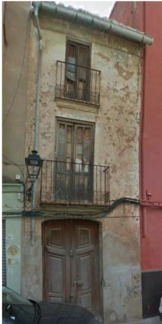
Figura 48/ Edificio deteriorado y cableado, Calle les Placetes/ Google Earth
