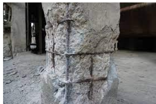
Figura 44/ Falta de recubrimiento mínimo de corrugas
