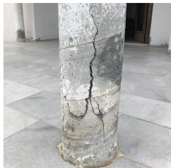
Figura 44/ Grietas en estructuras
