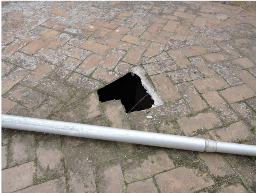
Figura 101/ Defecto de cubierta/ Diócesis Segorbe Castellón
