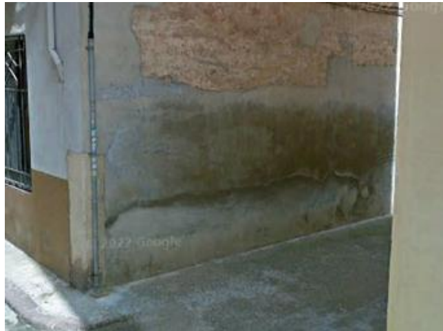
Figura 50/ Humedad edificio Calle Zaragoza/ Xavi Ríos
