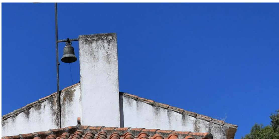
Imagen 21 - Ermita: presencia de vegetación en los faldones de la cubierta.
