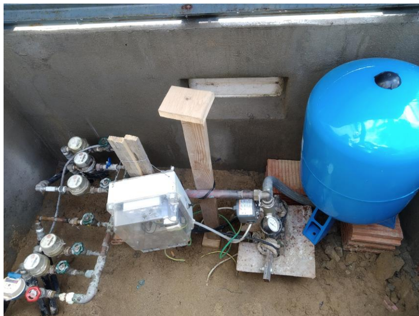
Imagen 6 - Bomba de agua y sistema de contadores individuales.
