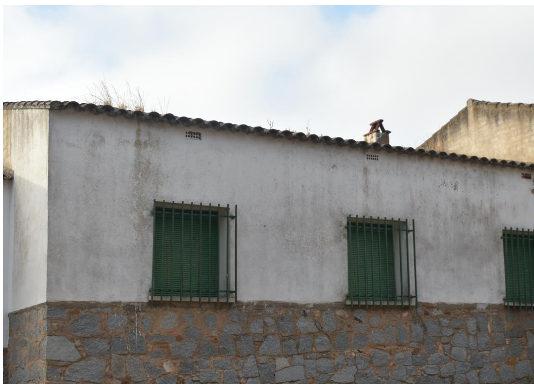
Imagen 12 - Vivienda 952: presencia de vegetación en los faldones de la cubierta.
