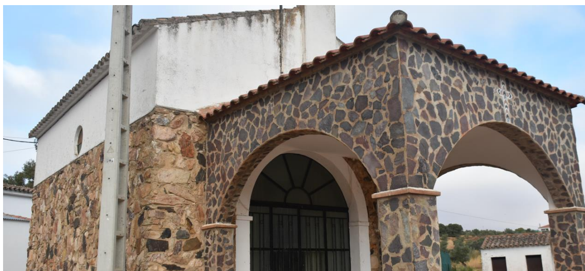
Imagen 19 - Ermita: manchas en el revoco de la fachada.
