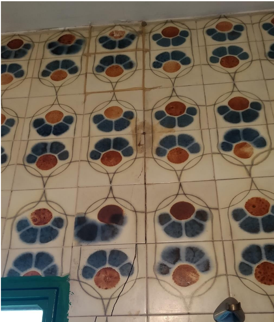
Imagen 15 - Vivienda 969: fractura de los elementos cerámicos del paramento.
