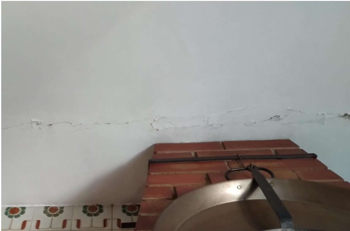
Imagen 17 - Vivienda 969: fisuras en el revoco del techo de la cocina.
