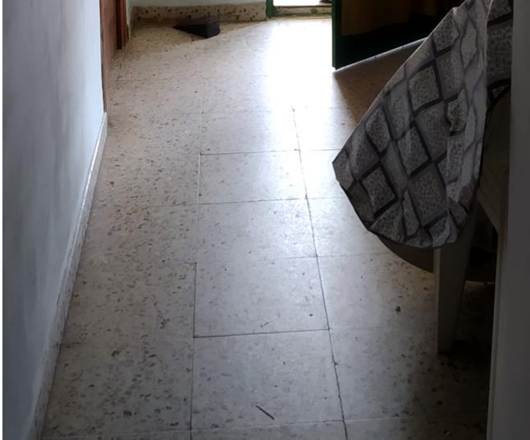
Imagen 16 – Vivienda 969: ejemplo de desgaste de las juntas en el pavimento.
