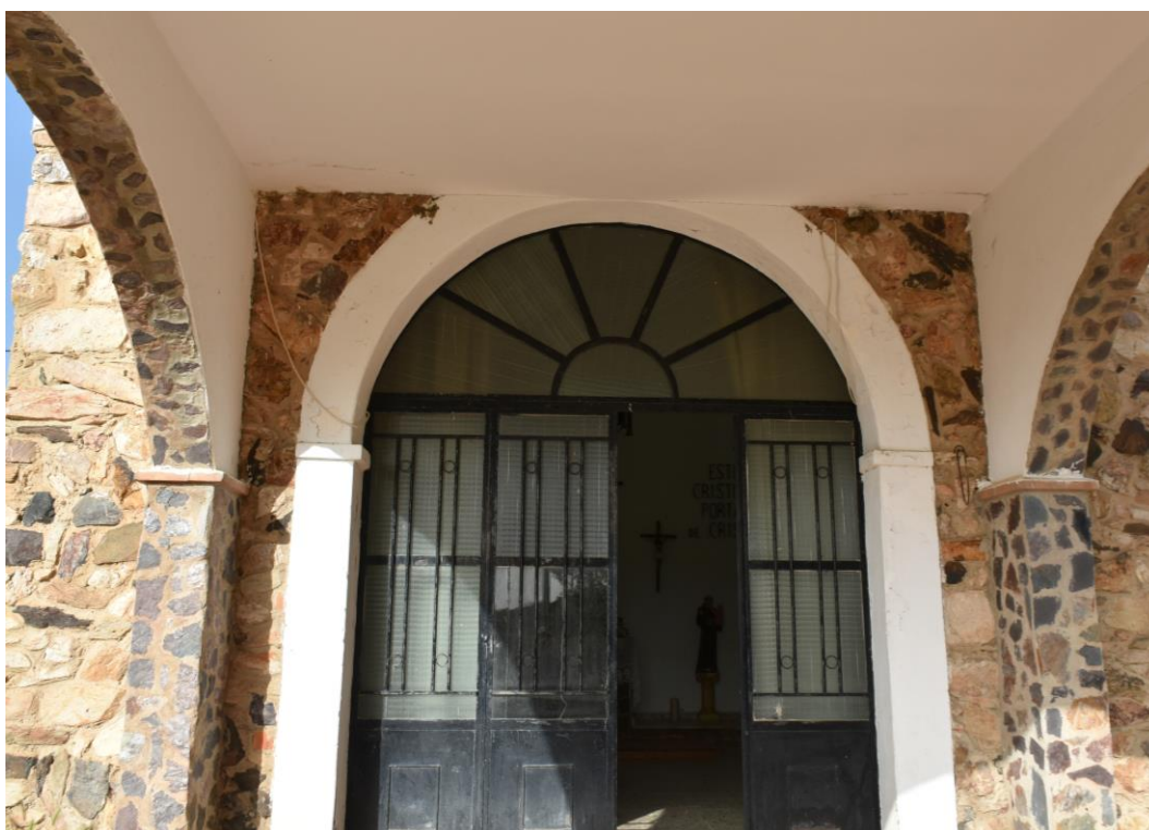
Imagen 18 - Ermita: estado actual de la carpintería.
