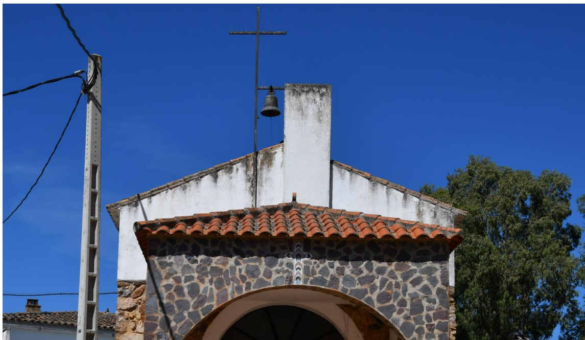
Imagen 20 - Ermita: manchas de humedad en la parte superior de los paramentos.
