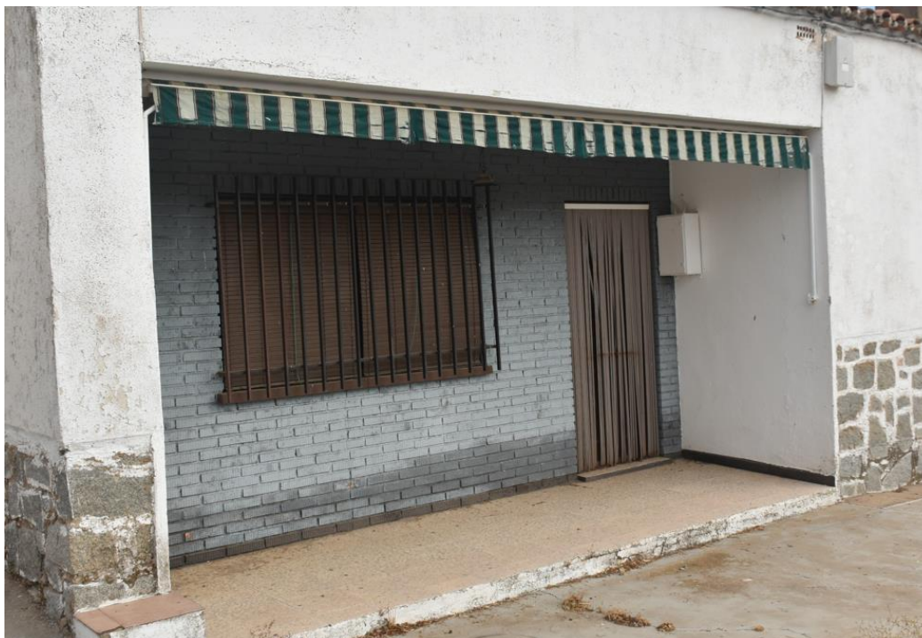
Imagen 7 – Vivienda 952: humedad por capilaridad en fachadas.
