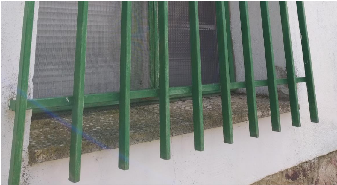
Imagen 11 - Vivienda 969: manchas y presencia de vegetación en el vierteaguas.
