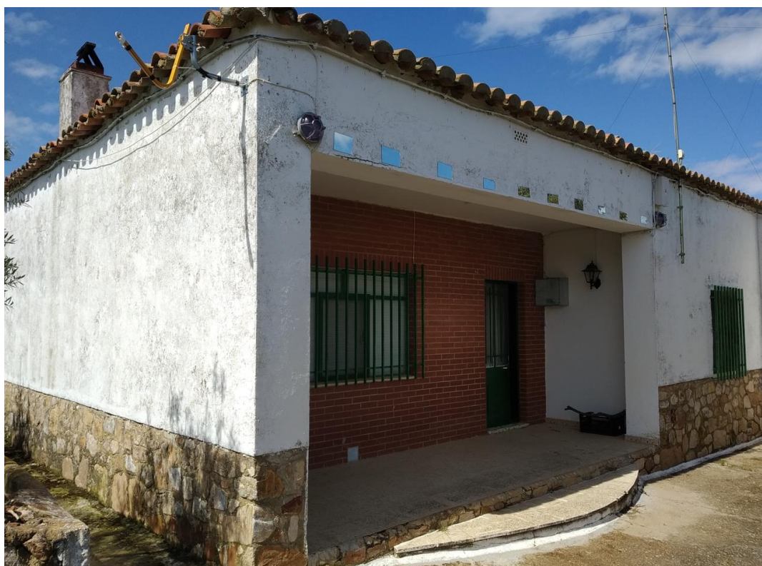
Imagen 8 – Vivienda 969: manchas en fachadas de forma generalizada.
