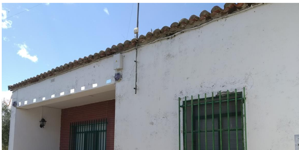
Imagen 9 – Vivienda 969: manchas en la parte superior de las fachadas.
