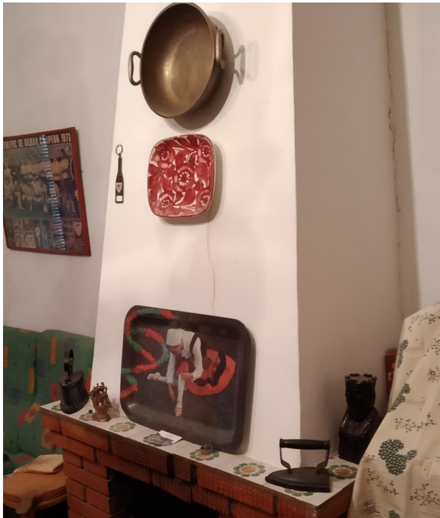
Imagen 14 - Vivienda 969: grietas en los laterales y zona central de la chimenea.
