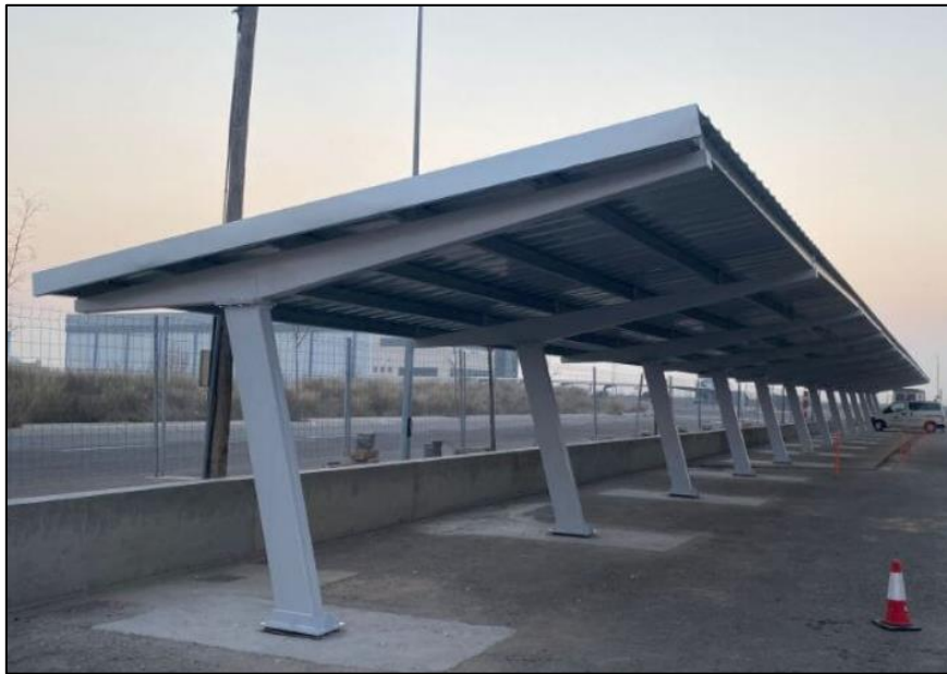
Figura 67. Pàrquing fotovoltaic instal·lat al lloc on va a realitzar-se la instal·lació fotovoltaica. Font: [22].
