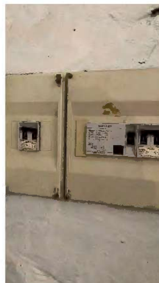
Ilustración 22. Cuadro general de protección, instalación eléctrica. Fuente: propia.
