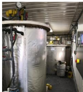
Figura 5: Digestor acidogénico y metanogénico de la planta piloto en la EDAR de Alcoy.
