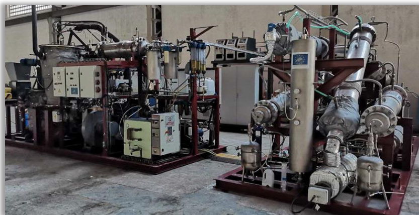
Figura 2. Planta piloto BPP (TRL7), consta de la unidad de gasificación (izquierda) acoplada a la unidad de síntesis de metilal (derecha).
