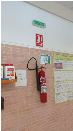
Foto 28: señales de evacuación y de incendios.
