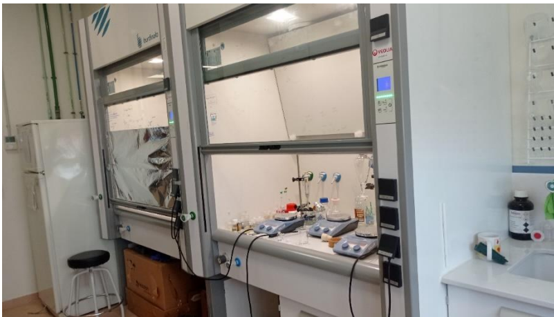
Foto 9: Campanas extractoras de humos. Fuente: Propia.
