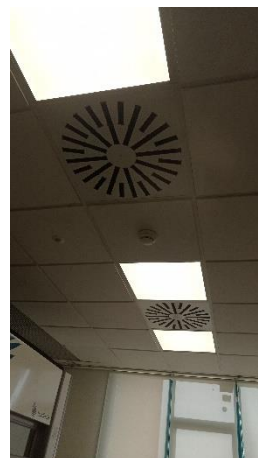
Foto 10: Luces, Aire acondicionado. Fuente: Propia.
