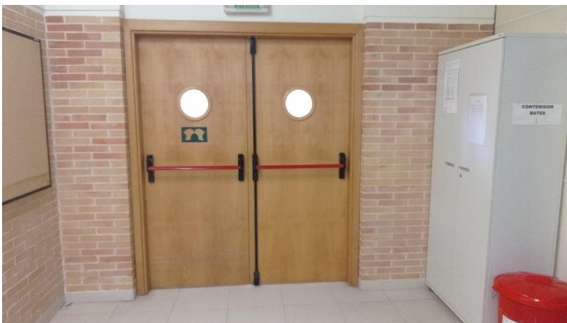
Foto 29: salidas de emergencia.
